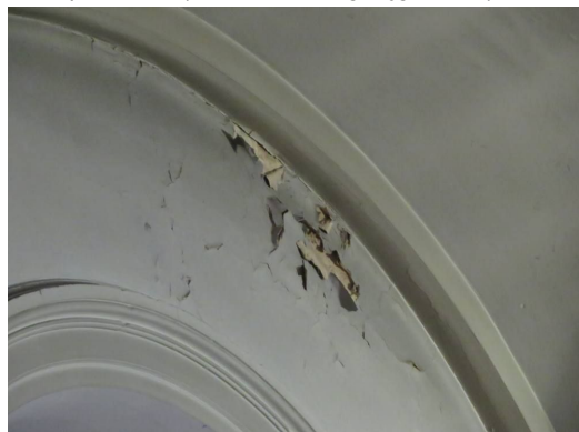
Vochtschade door oude waterinfiltraties.
