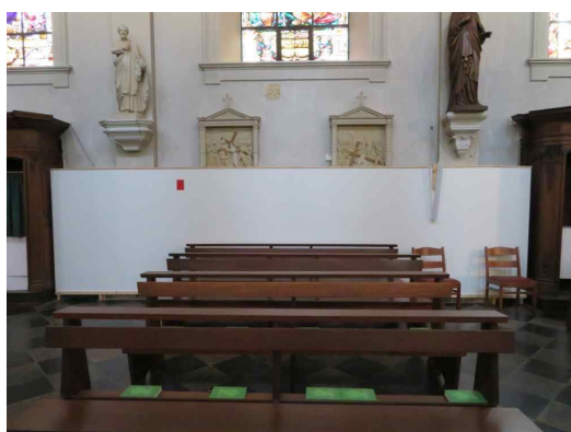
Afgekapte pleisterlagen achter de witte panelen.
