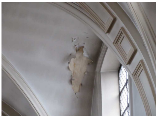
Vochtschade door oude waterinfiltraties.
