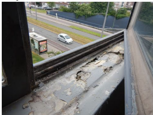
Beschadigde afwerking raam tablet wat resulteert in klemmen opengaande vleugels
