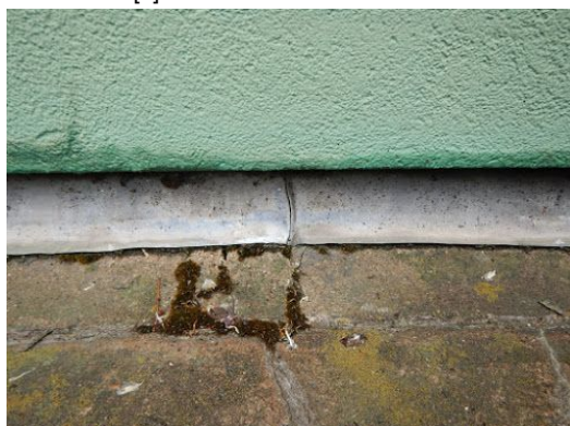
Scheuren loodslabben en onvoldoende minimumhoogte dakopstanden?
