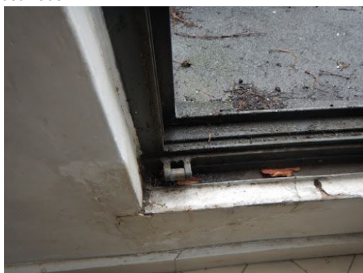
verkeerde detaillering condensgootje
