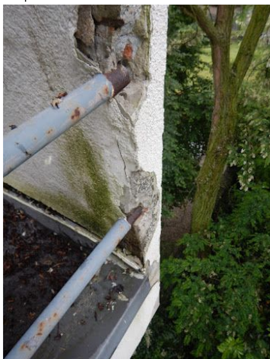
Beschadigd pleisterwerk borstwing
