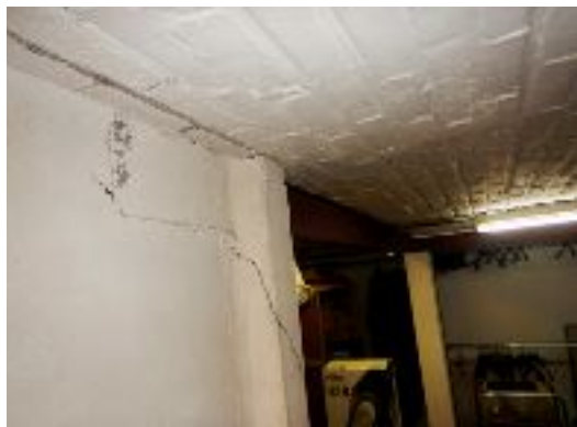
Opgedrukt metselwerk en scheurvorming
