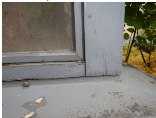
Beschadigd verfsysteem en lichte verwering sterk vochtbelaste delen schrijnwerk
