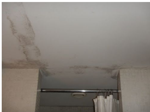
Schimmelvorming plafond badkamer
