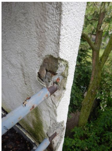
Roestige verankering borstwering balkon [3]
