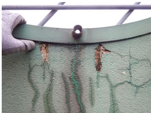
Vochtoverlast en beschadigd pleisterwerk
