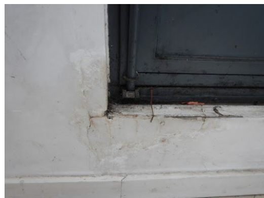
Schade aan de binnenafwerking
