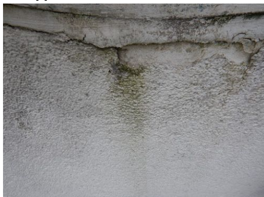
Beschadigd pleisterwerk ter hoogte van rond raam
