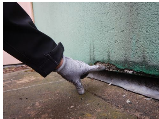
Zonneterras [2]: beschadigd pleisterwerk onderaan de muur
