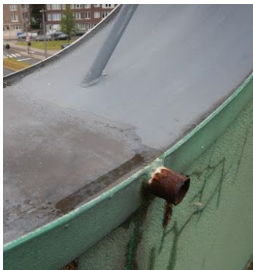
Ingescheurde las en te kleine oversteek raamomlijsting
