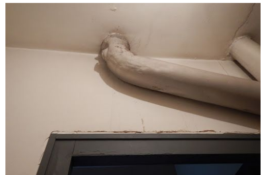
Zonneterras [2]: inpandige afvoer met lichte vochtschade rond de doorvoering
