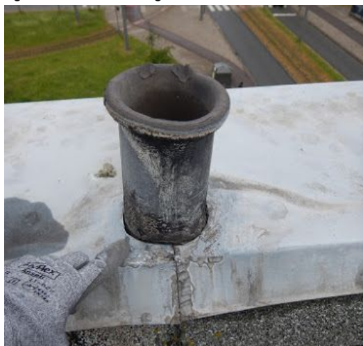
Verluchting niet waterdicht aangewerkt
