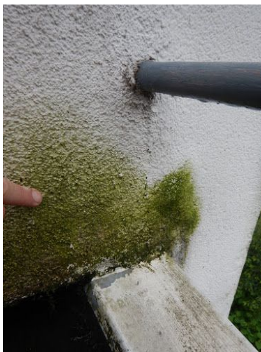
Balkon [4]: algengroei en lichte vochtschade ter hoogte tapgat door opspattend water
