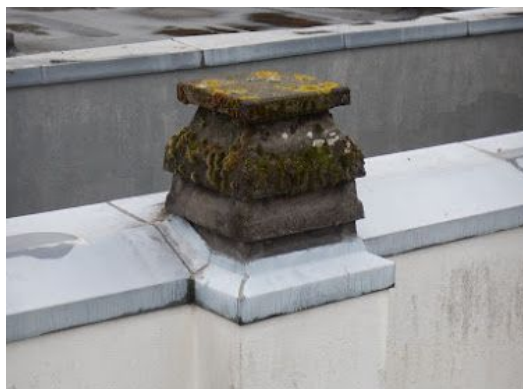
Detail losgescheurde aansluiting met schoorsteen
