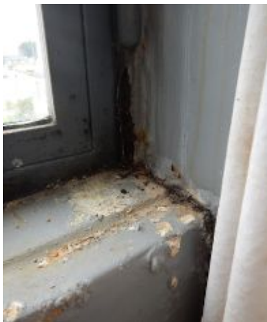
Vochtschade en roesten hoekpijlers
