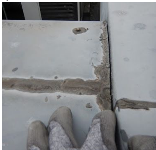
Ingescheurde naad in aansluiting buurgebouw
