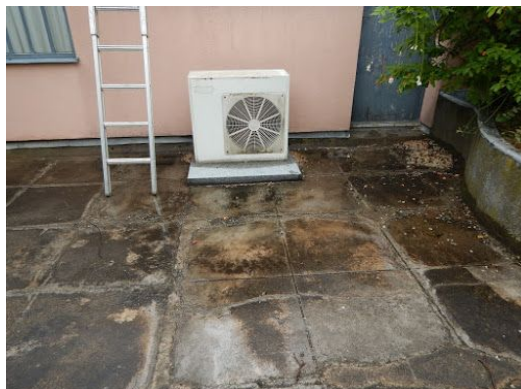
Slechte afwatering en gescheurde afwerking
