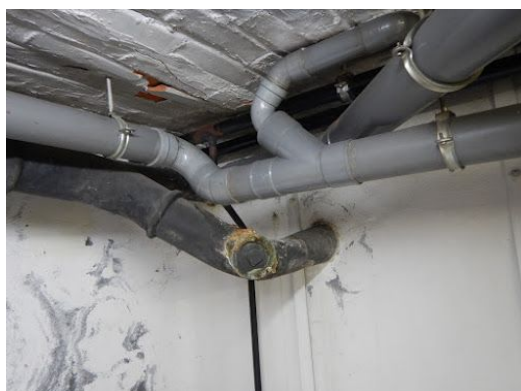
Beschadigd plafond door lekkende afvoer?
