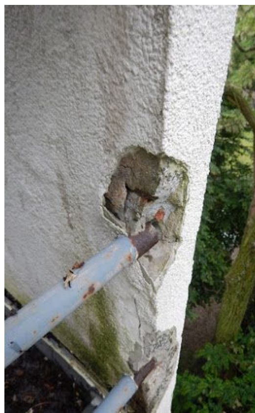
Beschadigde gemetselde borstwering
