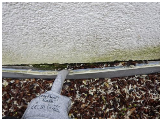
Losgescheurde aansluiting gemetselde borstwering
