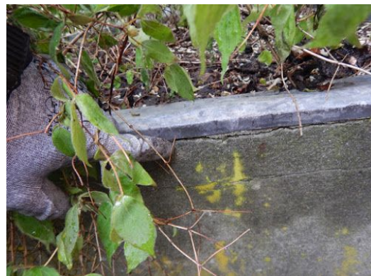
Gescheurde cementbepleistering onder de loden afdekking van de borstwering
