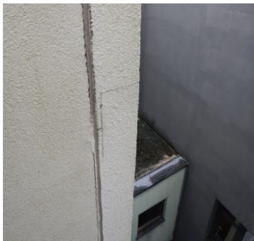
Balkon [3]: lichte aftekening aanzet isolatieplaten
