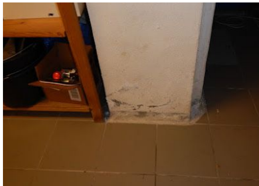
Beperkte schade door opstijgend vocht
