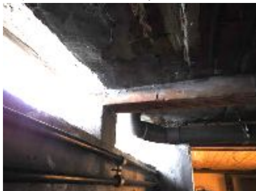
Later aangebrachte hulpconstructie vloerplaat
