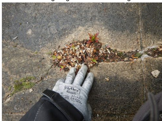
Plantengroei in de gescheurde imitatie betontegels
