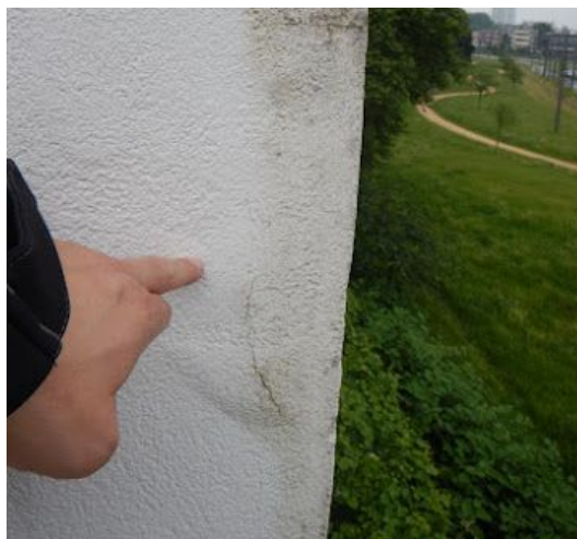
Balkon [4] lichte blaasvorming door roesten hoekprofiel?
