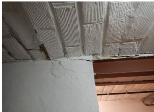
Verspreid schade door roesten ijzeren lateien
