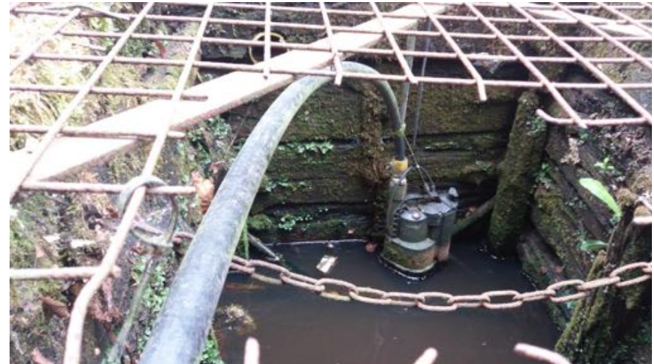
Figuur 46 - Dompelpomp en PE-buis in Berta 5
