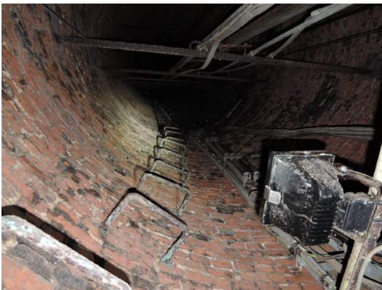
Afbeelding 40: Binnenkant van de schoorsteen met muurladder, in slechte staat. (Bron: Monumentenwacht)
