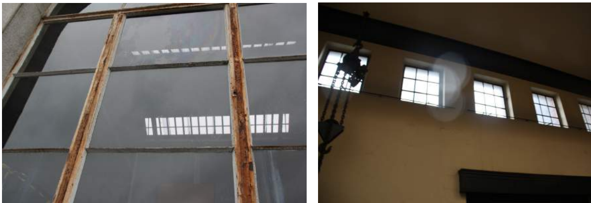
Afbeelding 50: Roestig schrijnwerk voorgevel
