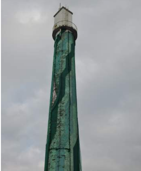
Afbeelding 39: Schoorsteen met afbladderende verf en draadnetten. (Bron: Monumentenwacht)
