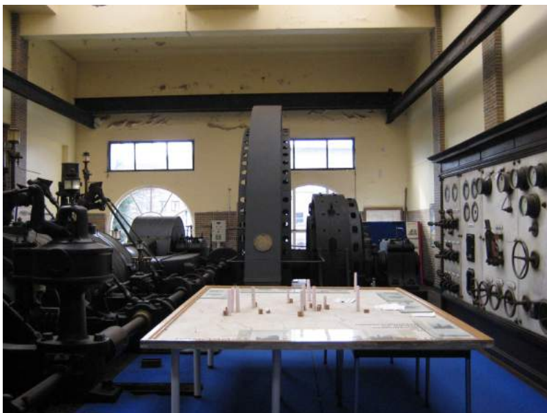
Afbeelding 53: Interieur van de machinezaal met afbladderende verf en scheurvorming in het pleisterwerk. (Bron: Maarten Dobbelaere)
