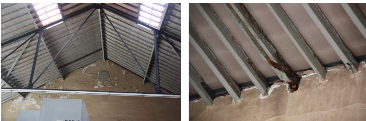
Afbeelding 43: Metalen spanten constructie zadeldaken, merk afbladderende verf op achterliggende muur op. Kopers met sporen van aantastingen. (Bron: Maarten Dobbelaere)
