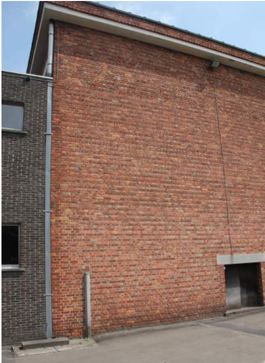
Afbeelding 52: Westelijke zijgevel met uitgespoeld voegwerk boven- en onderaan gevel, lekkende zinken regenwaterafvoer + houten poortje. (Bron: Maarten Dobbelaere)
