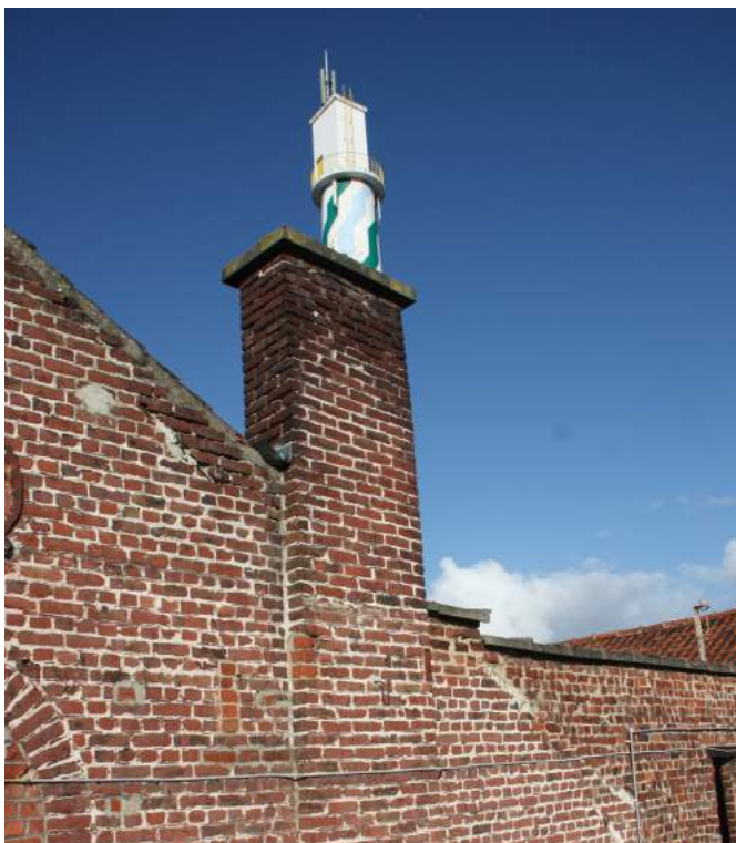
Afbeelding 49: Uitgespoelde mortel in gevel van schilddak met schouw, roestig muuranker. (Bron: Maarten Dobbelaere)
