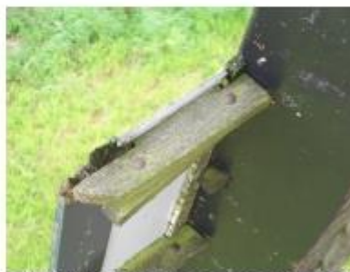
het uiteinde van de voorzoom is gedeeltelijk weggerot
