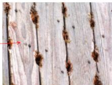
detail van de gaten
