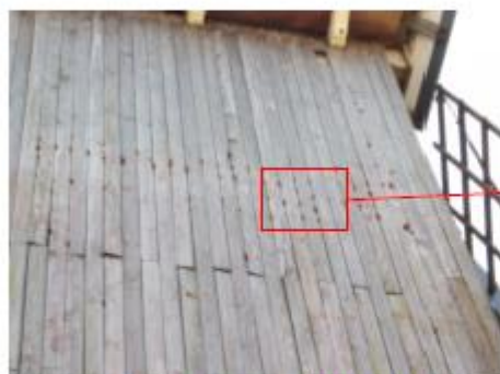
inspectie 2018: de zone met de gaten komt overeen met de plaats waar de middenlijsten zich situeren
