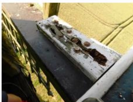
de keerklos is ernstig aangetast door houtrot en totaal verzwakt
