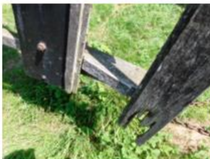
voorzoom: houten zoomlatten zijn aangetast door houtrot en de verbindingen met de hekscheien (kluffen) zitten los
