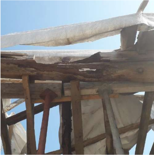
Afb. 71: Gebroken muurplaat boven poort.
