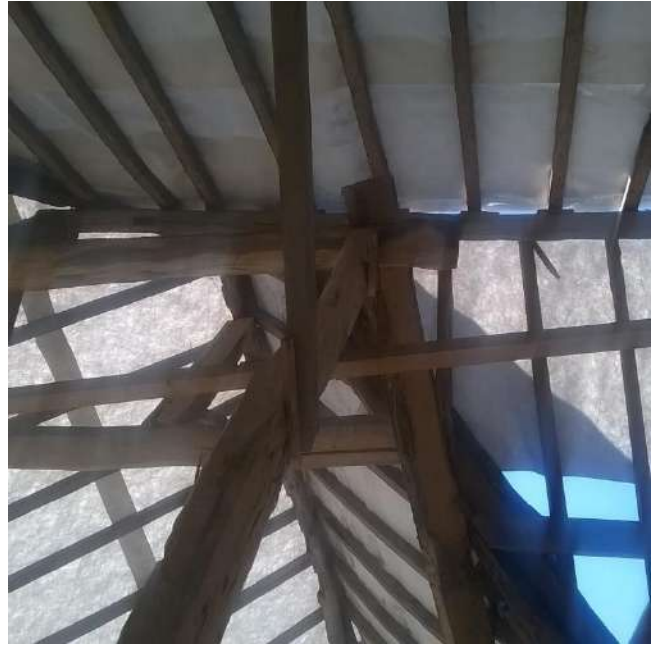
Afb. 72: Niet vakkundige verbinding tussen woonhuis en poorthuis.
