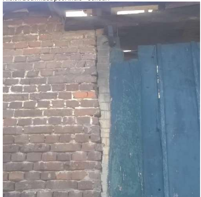
Afb.63: Niet vakkundige verbinding poort – straatgevel.
