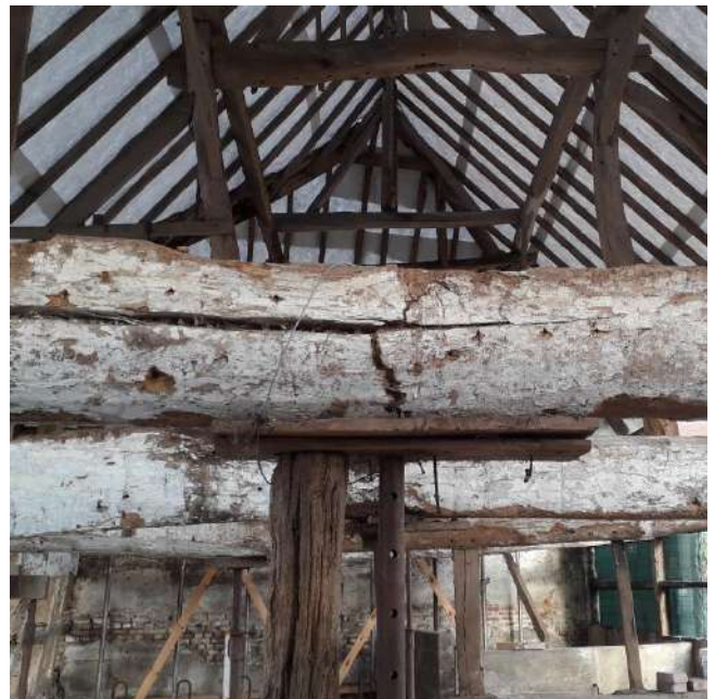
Afb. 82: Gebroken moerbalk op as 5.
