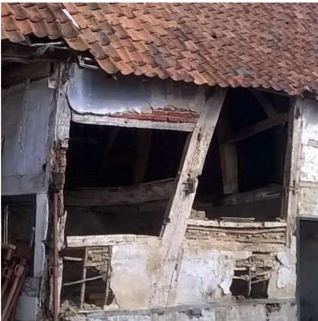
Afb. 69: Verwaarloosd vakwerk poorthuis.
