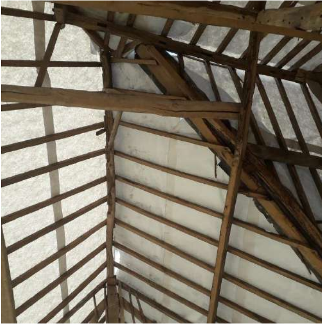
Afb. 87: Niet vakkundige verbinding Schuur-poorthuis.
