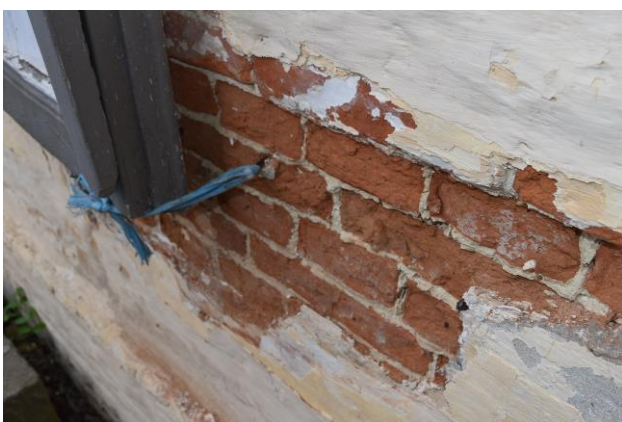
Figuur 3.3: Vorstschade tot op ca 1,5 meter
