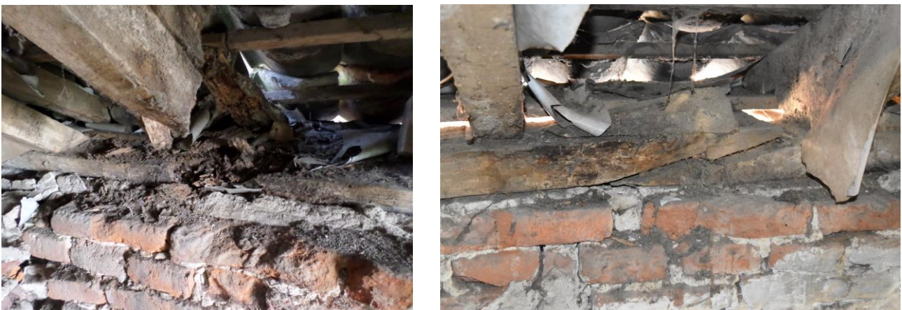
Figuur 3.77.a en 3.77.b: de moerbalken zijn rot als gevolg van de jarenlange vochtinsijpeling via het dak. De haaklassen zijn t.o.v. elkaar verschoven of verschoven.
