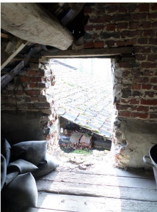
Figuur 3.73: De samenhang van het metselwerk is onderuit gehaald door de bijgemaakte opening in de watergevel, net onder de dakrand. De gording rust op het linteel van de bijgemaakte opening.
