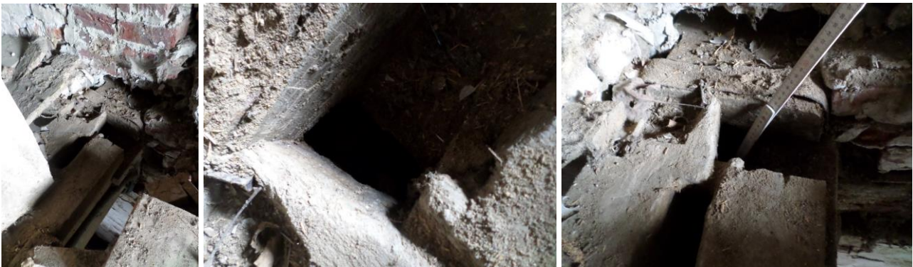
Figuur 3.74.a – 3.74.b – 3.74.c: Water is ingesijpeld tot in de kern van de moerbalken. Plooiometer gaat door de 'vide' van de moerbalkkop en komt er langs de onderzijde uit!!
