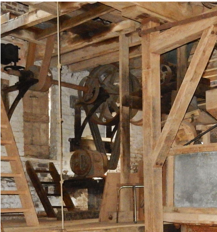
Figuur 3.62: elektromotor op de steenzolder
