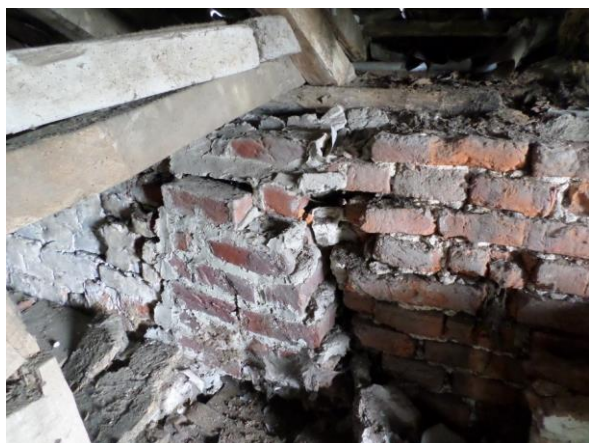
Figuur 3.78: de toestand van het metselwerk van de opkant uiterst links in de oostgevel is precair te noemen
