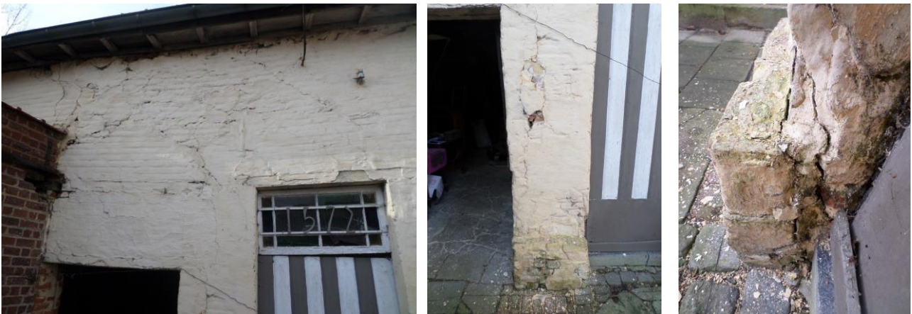
Figuur 3.75.a – 3.75.b – 3.75.c: Alle samenhang van het metselwerk boven de beide deuren is verdwenen. Vermoedelijk situeert het probleem zich hier ook op funderingsniveau.
