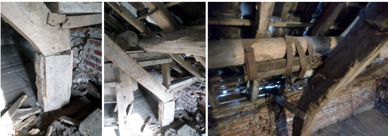
Figuur 3.76.a+b+c: het gebrek aan correcte verbindingen en knip- en plakwerk t.h.v. de dakstructuur
