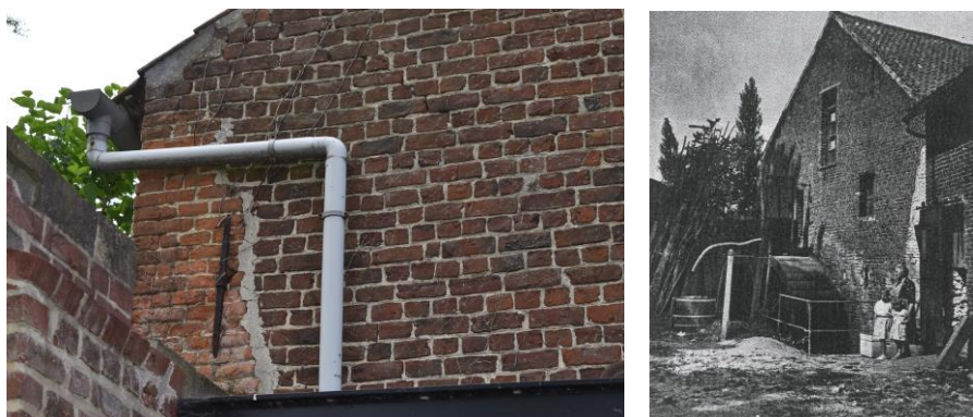
Figuur 3.9.a: Bouwnaad tussen oud en nieuw metselwerk langs de linkerszijde van de gevel (foto links)
