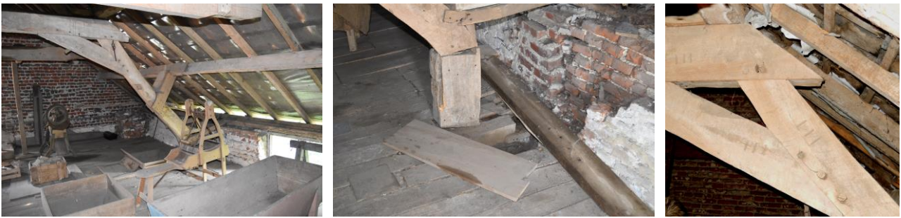
Figuur 3.33.a – 3.33.b – 3.33.c: Het spant van de zolder boven de molen, met van links naar rechts de opleg van de gording - een openstaande spantvoet en het verbroken metselverband van de opkant - het telmerk III
