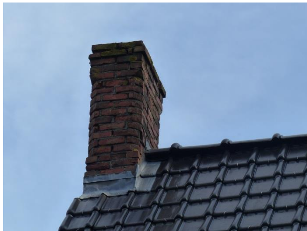
Figuur 23 Kalkvoegen schouw verweerd (17.10.2018)
