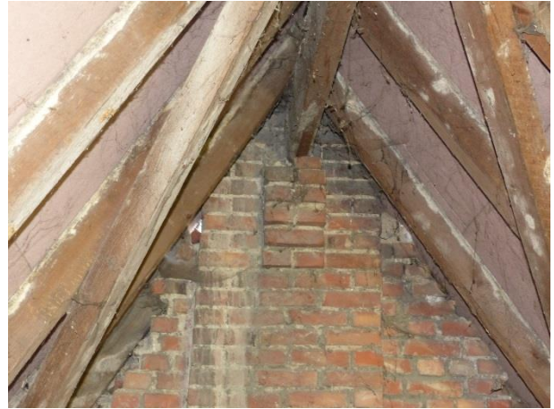
Figuur 36 Detail nok en kepers met oppervlakeschimmels; onderdak in vezelcementplaten (17.10.2018)
