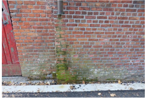
Figuur 28 Ontbrekende regenpijp, intussen hersteld (17.10.2018)
