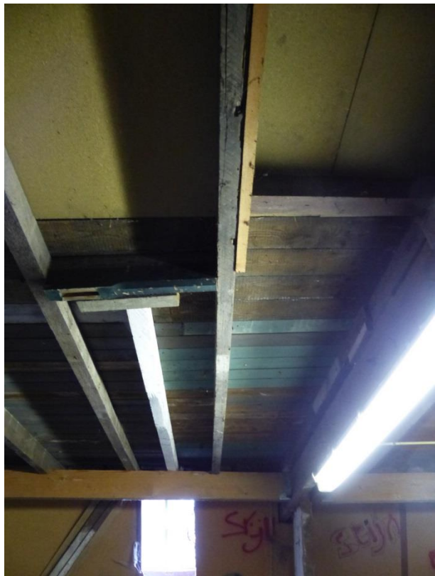
Figuur 78 Roostering onvakkundig hersteld (17.10.2018)
