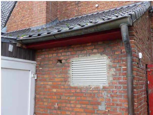
Figuur 39 Koperen hanggoot hangt door (17.10.2018)
