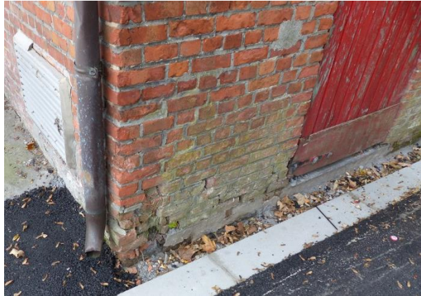
Figuur 21 Annex: lacunes in metselwerk
