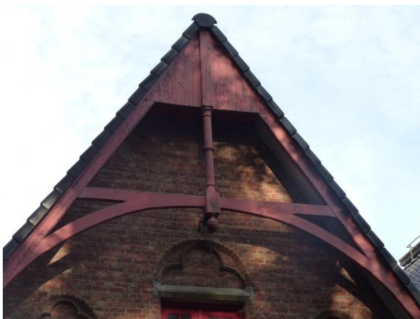
Figuur 37 Barsten in hout + schilderwerk bladdert af (17.10.2018)
