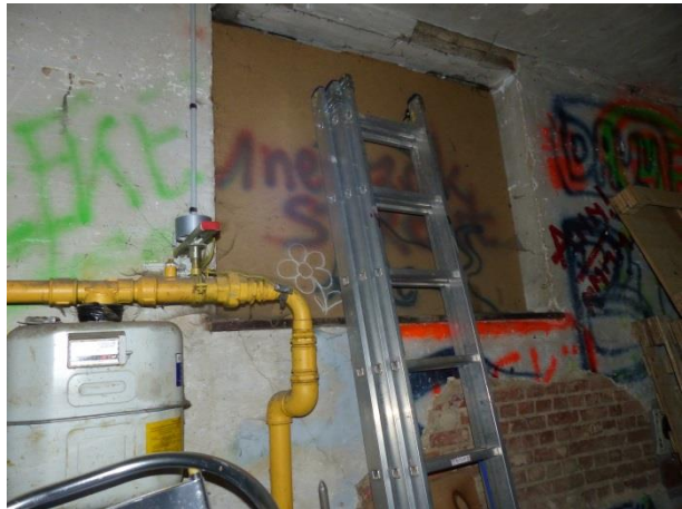
Figuur 69 Linkerzijgevel: Lacunes in pleisterwerk (17.10.2018)
