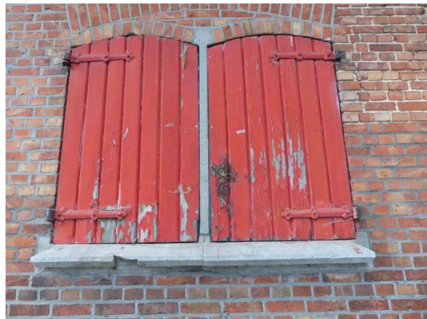
Figuur 30 Raamdorpel zijgevel gebarsten (17.10.2018)
