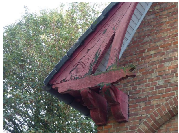
Figuur 38 Schilderwerk bladdert af; PVC-planchetten aan onderzijde (17.10.2018)
