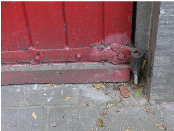
Figuur 55 Poorten: duim vervangen door draadstang. Onderzijde afgesloten (17.10.2018)
