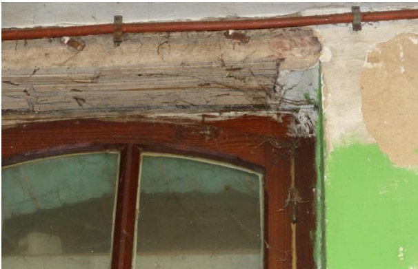
Figuur 57 Ramen: corrosie metalen onderdelen (17.10.2018)
