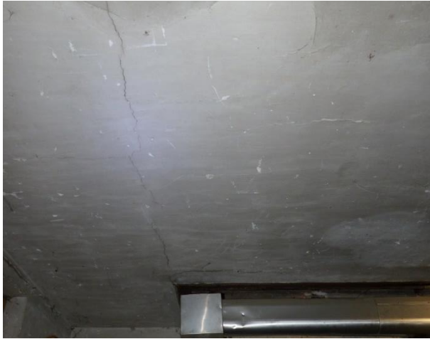
Figuur 72 Barst in plafondbepleistering (17.10.2018)
