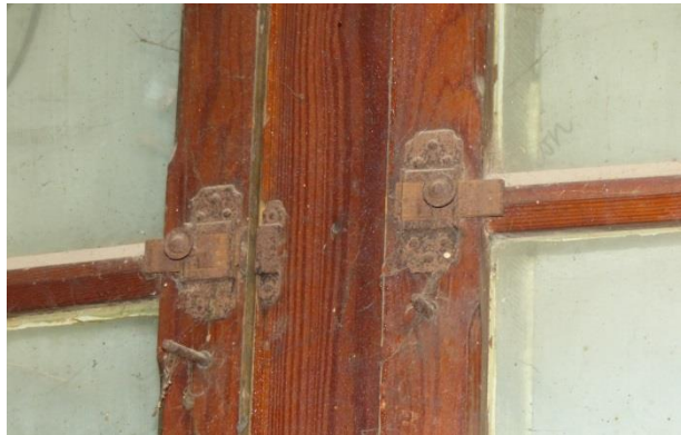
Figuur 58 Ramen: corrosie metalen onderdelen (17.10.2018)
