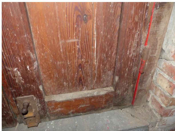
Figuur 62 Corrosie metalen onderdelen (17.10.2018)
