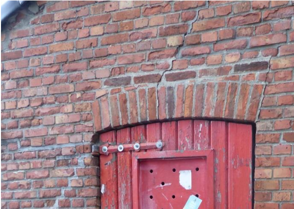
Figuur 20 Annex: vorstschade, hersteld voegwerk, barsten (17.10.2018)
