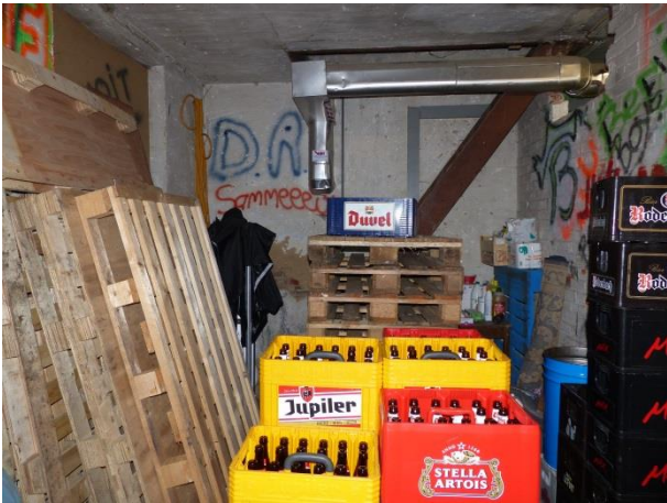
Figuur 68 Zicht op achterwand hoofdvolume. Ramen zijn aan de binnenzijde afgeschermd. Pleisterwerk sterk beschadigd. (17.10.2018)
