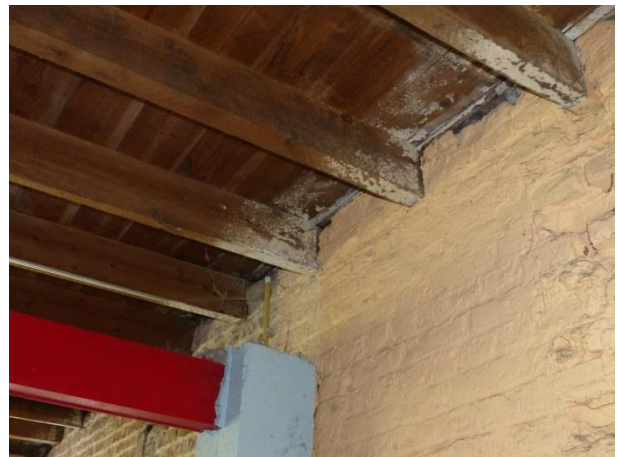
Figuur 106 Schuur: Oppervlakteschimmel t.h.v. inklemming balken (17.10.2018)
