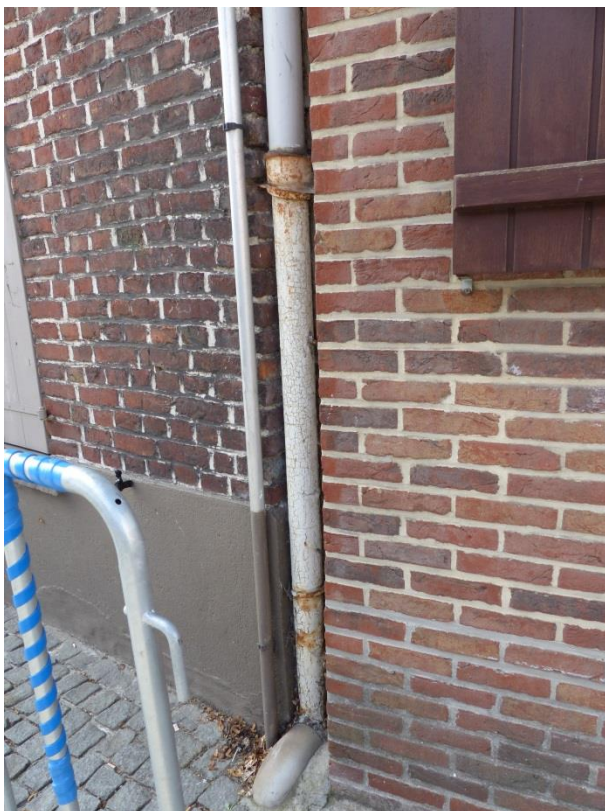
Figuur 48 (links) en Figuur 49 (rechtsboven) Voorgevel: regenpijp verdiept geplaatst in nis tussen twee panden. Dolfijnstuk gecorrodeerd (17.10.2018)
