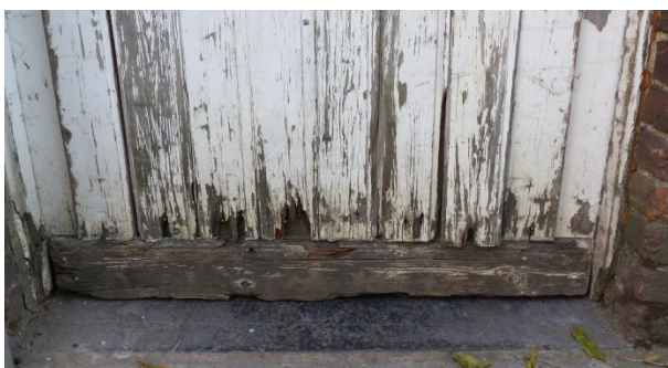
Figuur 97 Onderzijde deur in slechte staat (17.10.2018)
