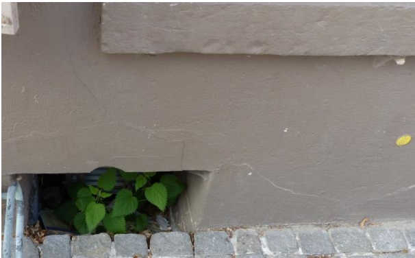
Figuur 21 Scheuren in gecementeerde plint (17.10.2018)
