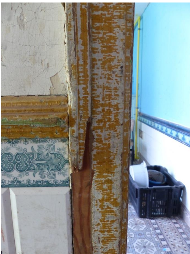
Figuur 144 Deur gang > keuken: deurlijst beschadigd (17.10.2018)
