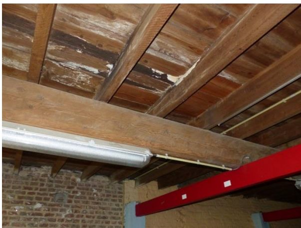
Figuur 107 Schuur: aantasting roosting (17.10.2018)
