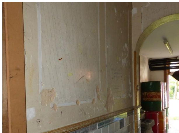
Figuur 118 Beschadigd kalkpleisterwerk (17.10.2018)
