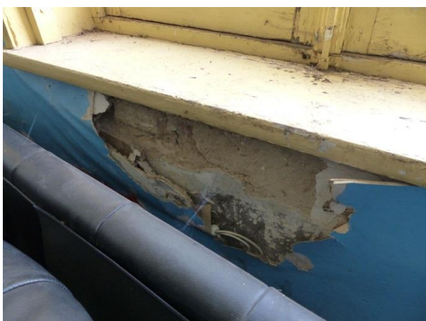
Figuur 119 Lokaal 3: beschadigd pleisterwerk (17.10.2018)
