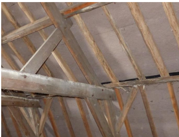
Figuur 57 Gording: vezelig rot (witrot) t.h.v. opleg spant II (17.10.2018)
