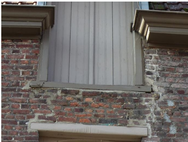
Figuur 17 Scheuren en herstellingen tweede travee schuur. (17.10.2018)
