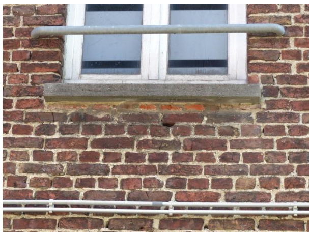
Figuur 40 Lacunes in voegwerk in kalkmortel. Dorpel in prefabbeton, ondermetseld. (17.10.2018)
