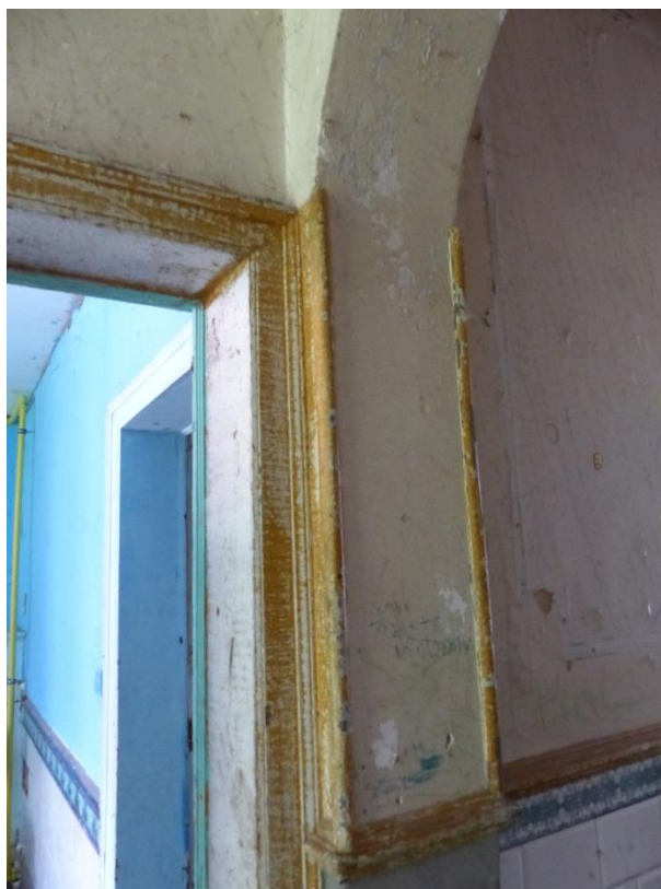
Figuur 145 Deur gang > keuken lijst loopt over in afwerking penant (17.10.2018)
