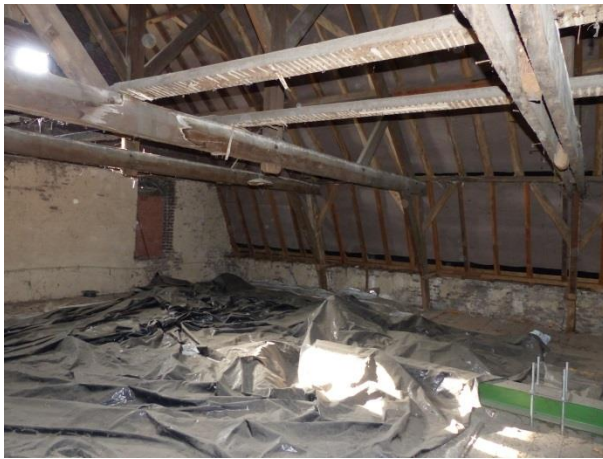
Figuur 55 Sporen van vochtinfiltratie en oppervlakteschimmel op hanenbalk van spant III (17.10.2018)
