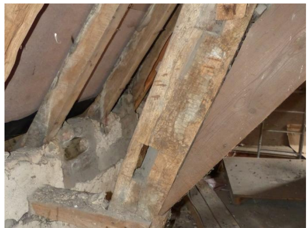
Figuur 58 Kubisch rot bij spant II. Korbeel reeds vervangen (17.10.2018)
