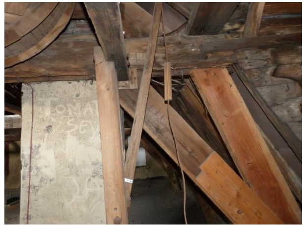
Figuur 56 Sporen van vochtinfiltratie bij spant III en beboarding dakuitbouw. De stijl van het spant is vernieuwd. Vezelig rot t.h.v. kop hanenbalk (17.10.2018)
