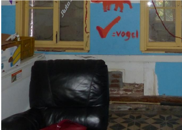
Figuur 121 Lokaal 3: gipskarton langs voorgevel (17.10.2018)
