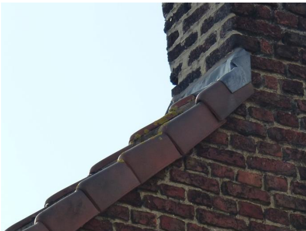
Figuur 44 Aansluiting met puntgevels. Mosvorming. Zinken aansluitingen (17.10.2018)
