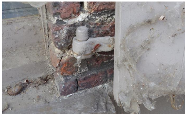
Figuur 24 Metselwerk lokaal gebarsten t.h.v. inklemming luikduimen (17.10.2018)
