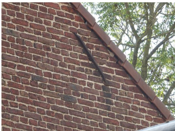
Figuur 28 Verontreiniging metselwerk door corrosie muuranker (17.10.2018)
