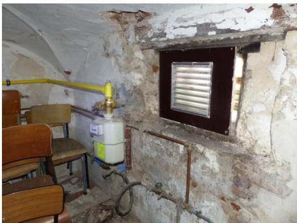
Figuur 117 Detail wandbepleistering kelder (17.10.2018)
