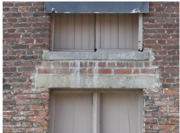
Figuur 18 Herstellingen tweede travee schuur t.g.v. stabiliteitsprobleem (17.10.2018)
