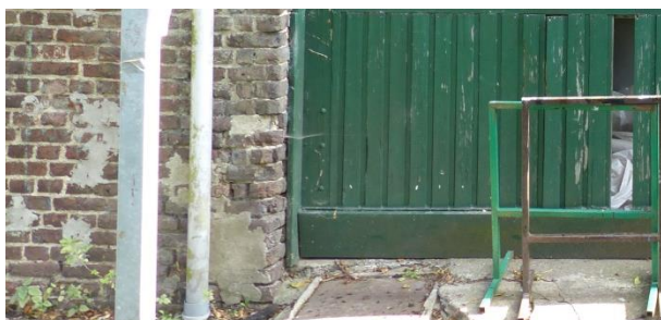
Figuur 36 Lacunes in metselwerk (17.10.2018)
