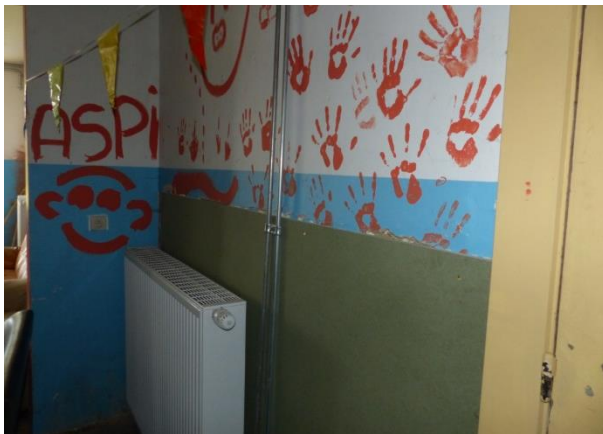
Figuur 123 Lokaal 3: MDF-plaat langs gang (17.10.2018)
