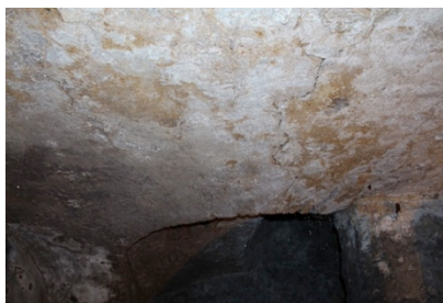
Afbeelding 151: Scheur keldergewelf woning 13/2
