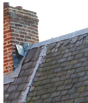
Afbeelding 163: Hagelschade noordelijk dakvlak woning 15
