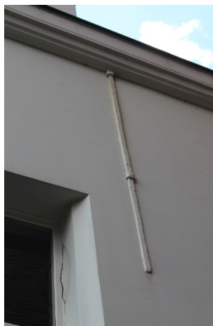
Afbeelding 135: Roestige gevelankers binnentuin
