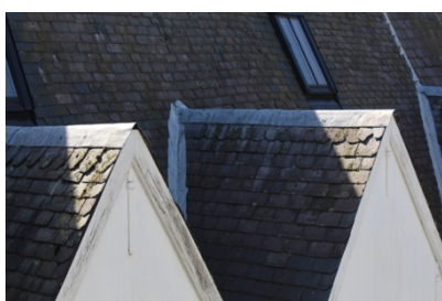
Afbeelding 158: Noordelijk dakvlak woning 13/5, hagelschade en verwerking windveren van de standvensters
