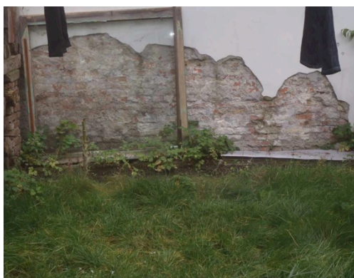
Afbeelding 137: Zijgevel woning 13/3 aan tuin woning 13/4 (Monumentenwacht, 2015)
