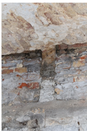
Afbeelding 84: Moneel in kelderraam van woning 13/2
