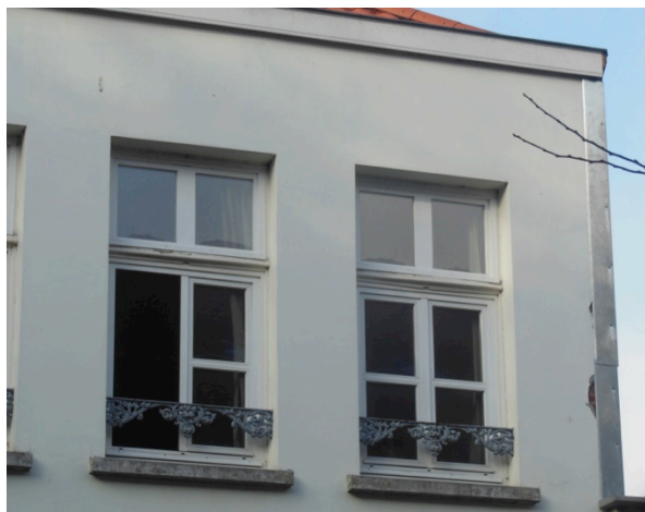
Afbeelding 136: Beginnende roestvorming op borstweringen en beschadigd pleisterwerk t.h.v. scheidingsmuur met Vekestraat 16-18
