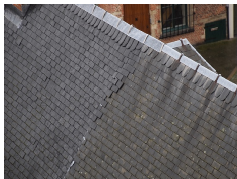
Afbeelding 142: Overgang daken voorhuis nr. 11 en 13 en roestige nokbeugels
