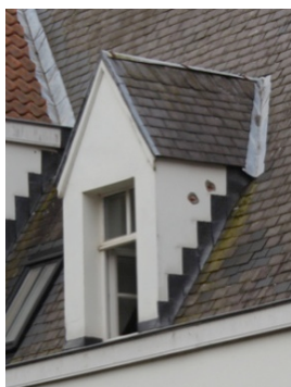
Afbeelding 140: Vochtig pleisterwerk van standvenster, woning 13/5
