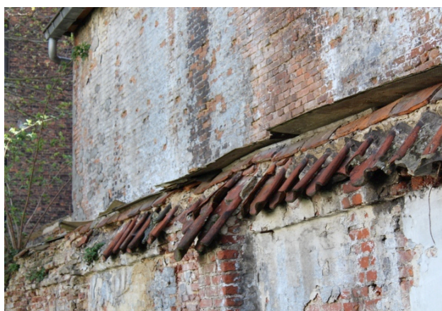
Afbeelding 166: Asbesthoudende platen en oorspronkelijke pannen, tuinmuur woning 13/5
