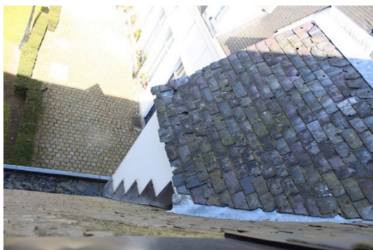
Afbeelding 161: Hagelschade noordelijk standvenster woning 13/5
