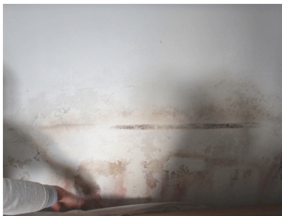
Afbeelding 172: Vochtschade scheidingsmuur, woning 13/7
