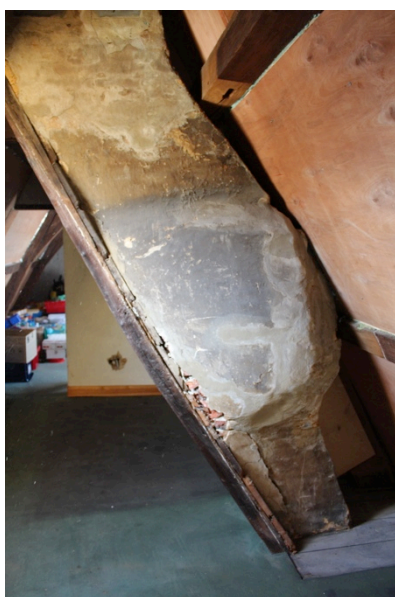
Afbeelding 174: Schade aan schouwlichaam woning 13/2
