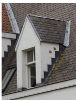
Afbeelding 155: Beschadigd pleisterwerk van standvenster woning 13/5
