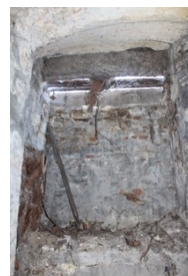
Afbeelding 154: Boomgroei en uitgespoeld voegwerk woning 13/6
