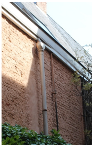
Afbeelding 134: Niet-opgespannen gevelanker aan scheidingsmuur nr. 17
