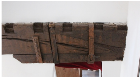
Afbeelding 72: Balkkop ter hoogte van trappenhuis, oude herstellingen, woning 13/2
