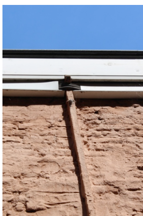
Afbeelding 164: Gedeeltelijk onbedekte bekabeling scheidingsmuur nr. 17
