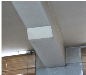
Afbeelding 71: Bepleisterde moerbalk woning 13/6
