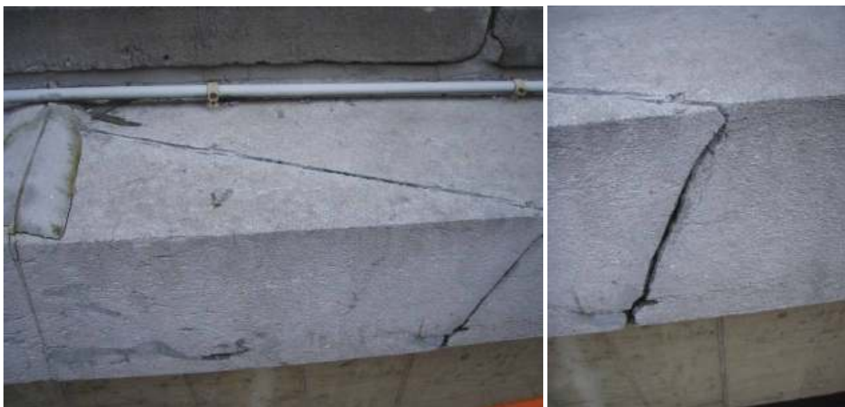
Vleugel [7]-zuid, scheurvorming in de waterlijst.
