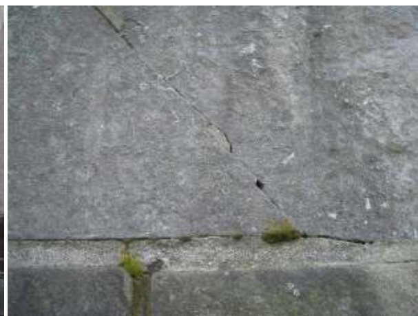
Vleugel [2]-west, scheurvorming in de flank van het noordelijke schouderstuk.
