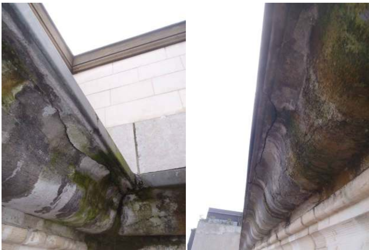
Vleugel [4]/[6], scheurvorming in de blauwe steen van de kroonlijst (door roestvorming aan de vernageling van de bekleding).
