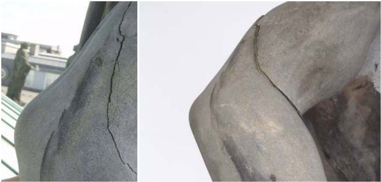
Scheurvorming bovenop elleboog 2011 en nu.
