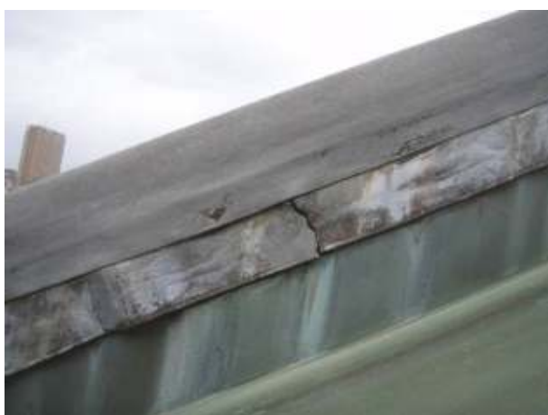
Dak [1]-,noord, ingescheurde loodaansluiting aan middelste koepel.
