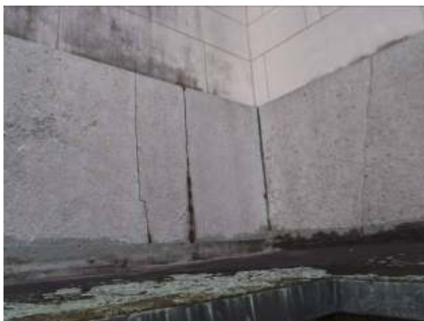
Vleugel [4]/[6], scheurvorming in de strook boven de noordelijke kroonlijst.
