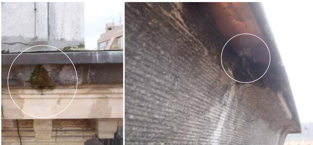
Vleugel [6]-oost, voor en na verwijderen van het loszittend stuk (door roestvorming aan de vernageling van de bekleding-rechtese cirkel).
