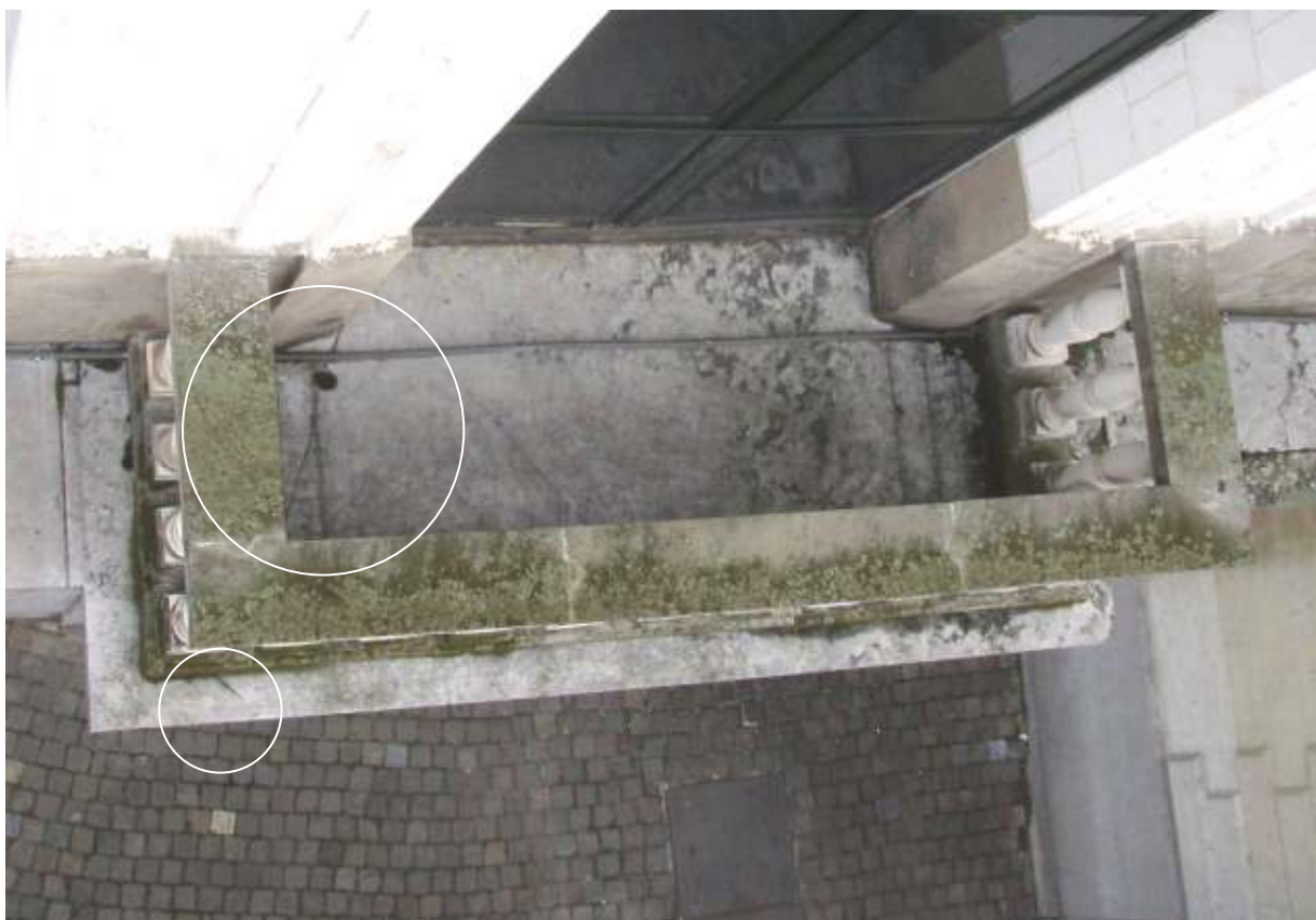
Vleugel [2]-zuid,afbrokkelen oppervlak balkonvloer en in cirkel: scheurvorming.
