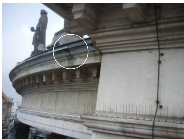
Dak [3], zuidoostelijke hoek (gevolg gescheurde soldeernaad).
