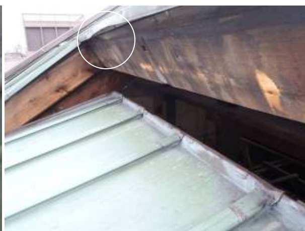
Dak [1]-noord, opgewaaide koperaansluiting bovenaan middelste rookkoepel.
