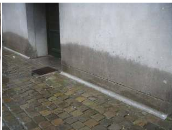
Vleugel [7]-zuid, uitgespoeld voegwerk van de plint.
