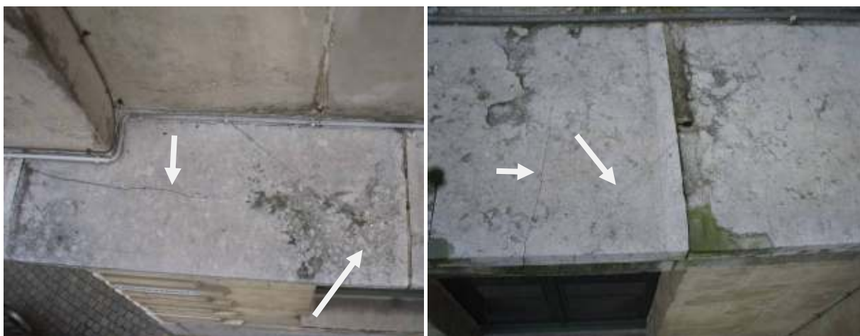
Vleugel [2]-zuid, scheurvorming in de westelijke hoek van de waterlijst.
