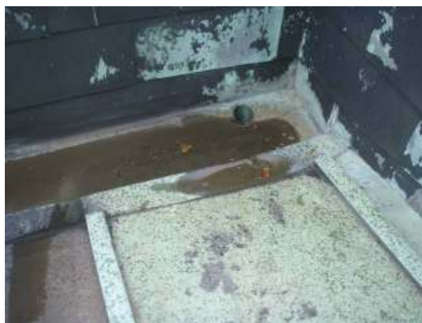
Dak [6], verzakking in de noordoostelijke hoek.
