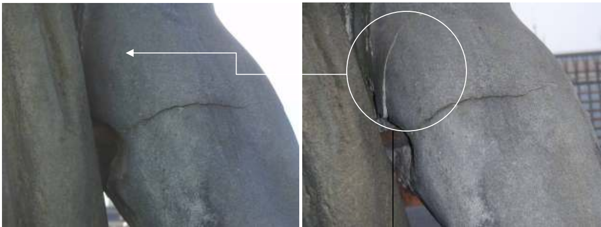
Scheurvorming onderaan elleboog 2011 en nu.
