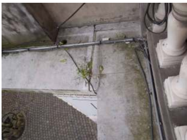
Vleugel [2], plantengroei in beschadigde voegwerk van de waterslijst in de noordwestelijke hoek.
