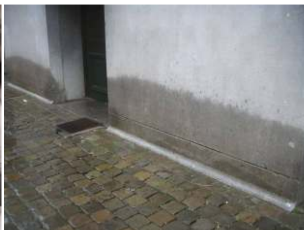
Vleugel [7]-zuid, uitgespoeld voegwerk van de plint.
