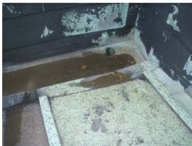
Dak [6], verzakking in de noordoostelijke hoek.
