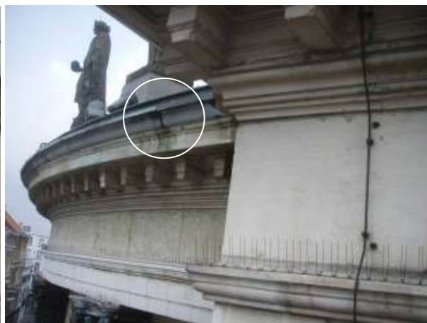
Dak [3], zuidoostelijke hoek (gevolg gescheurde soldeernaad).
