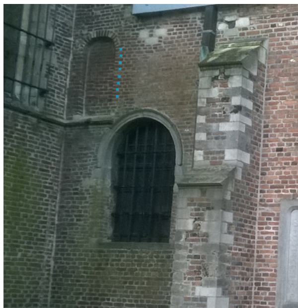
afb. 86: Aanduiding klezortjes in overgang nis - muurwerk
