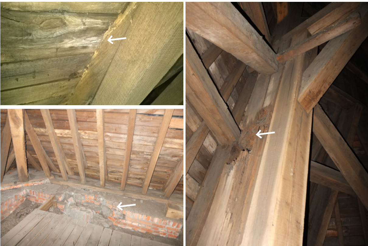
afb. 230: Afgebrokkeld metselwerk in de toren en ingerotte houten onderdelen, sporadisch komt aantasting door houtboorders voor
