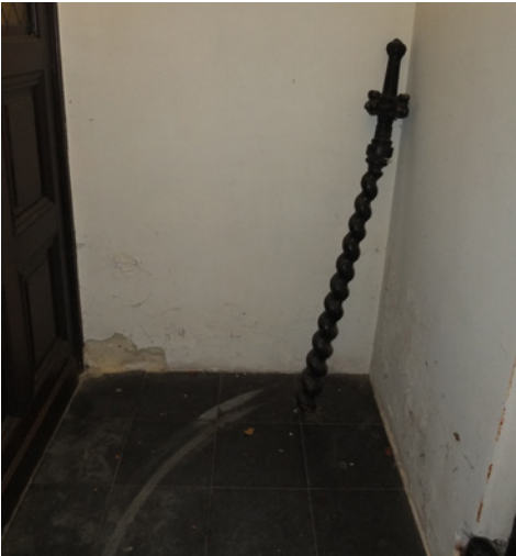
afb. 232: Losgekomen onderdeel van het hekwerk
