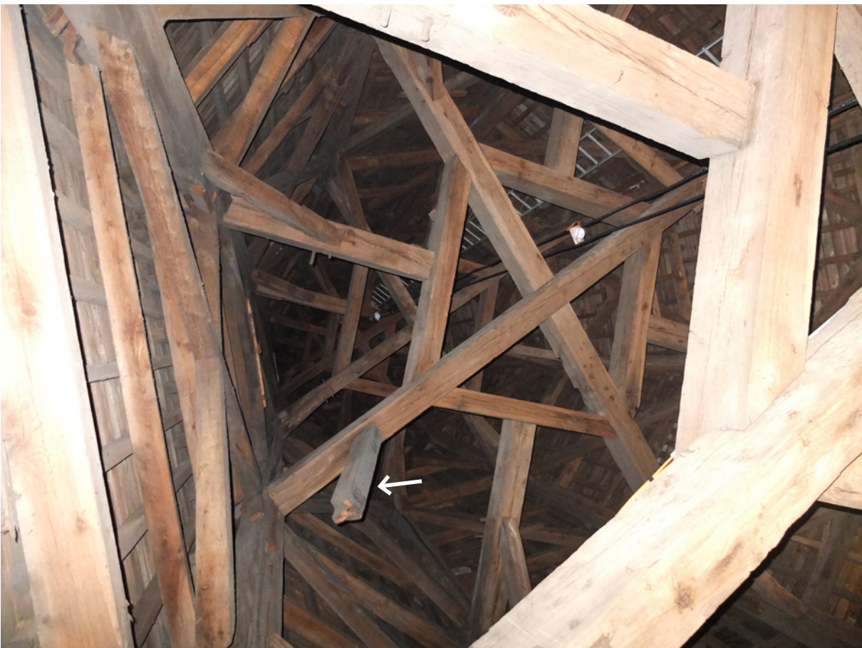
afb. 229: Losgekomen houtverbindingen in de toren
