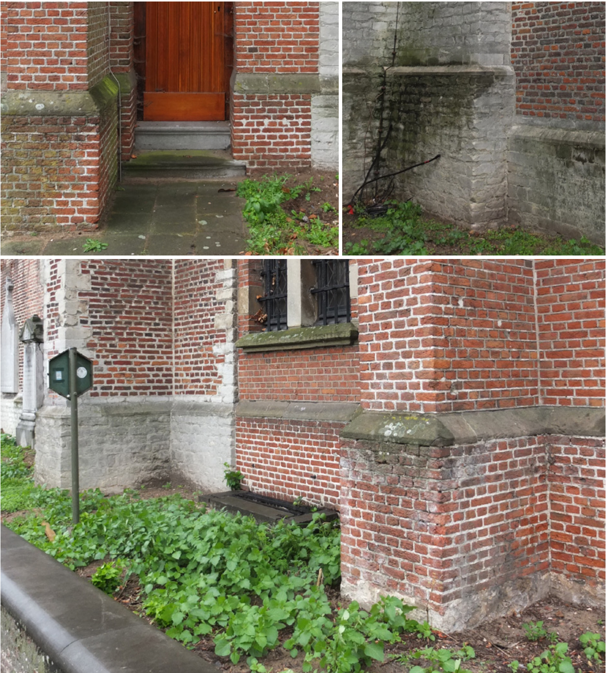
afb. 231: Uitgespoeld voegwerk dat hersteld moet worden
