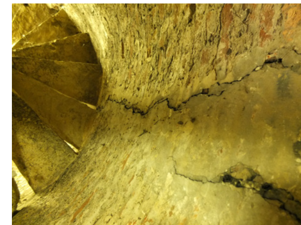
afb. 181: Scheuren in de traptoren
