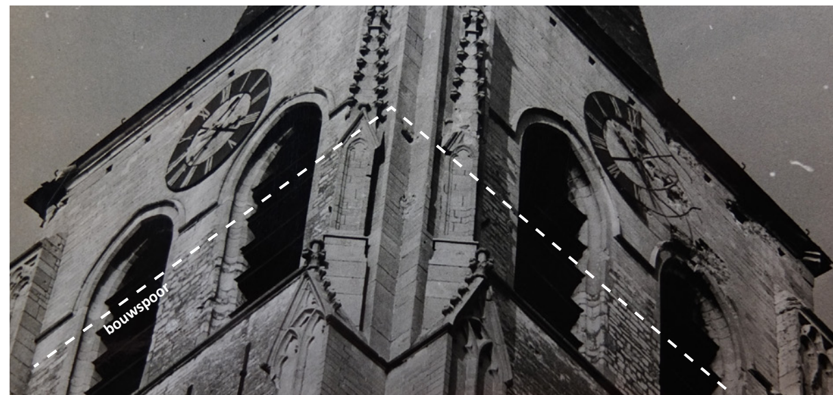
afb. 51: Foto van de beschadigingen aan de kerktoeren, WOII, duidelijk verschil tussen oudere en nieuwe witte steen ©DAN
