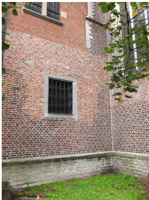
afb. 95: Aanduiding klezootjes in overgang nis - muurwerk
