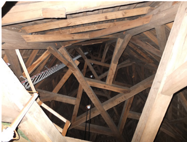
afb. 240: Moeilijk bereikbare onderdelen waardoor verbeteringen nodig zijn
