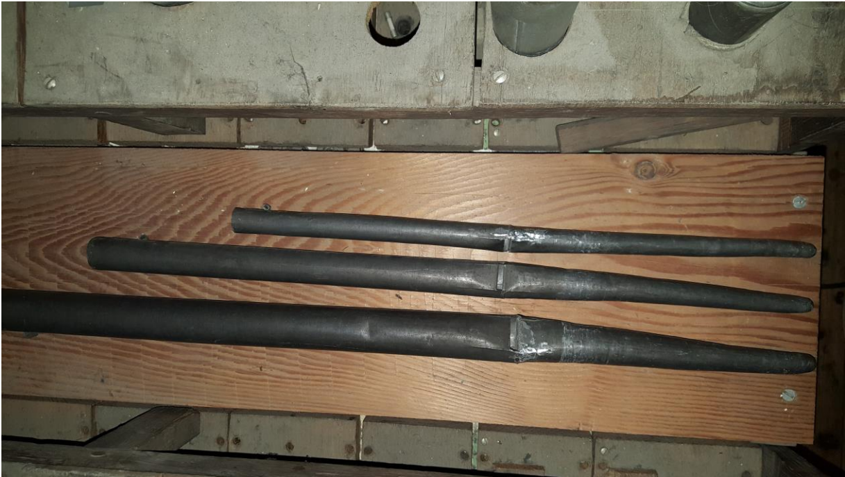
meer of min sterk beschadigt en getransformeerd pijpwerk van Forceville
