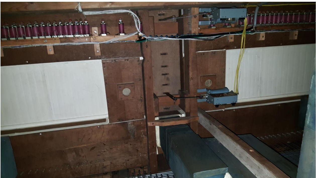
elektrische tractuur achterliggende ventielkast hoofdwerk
