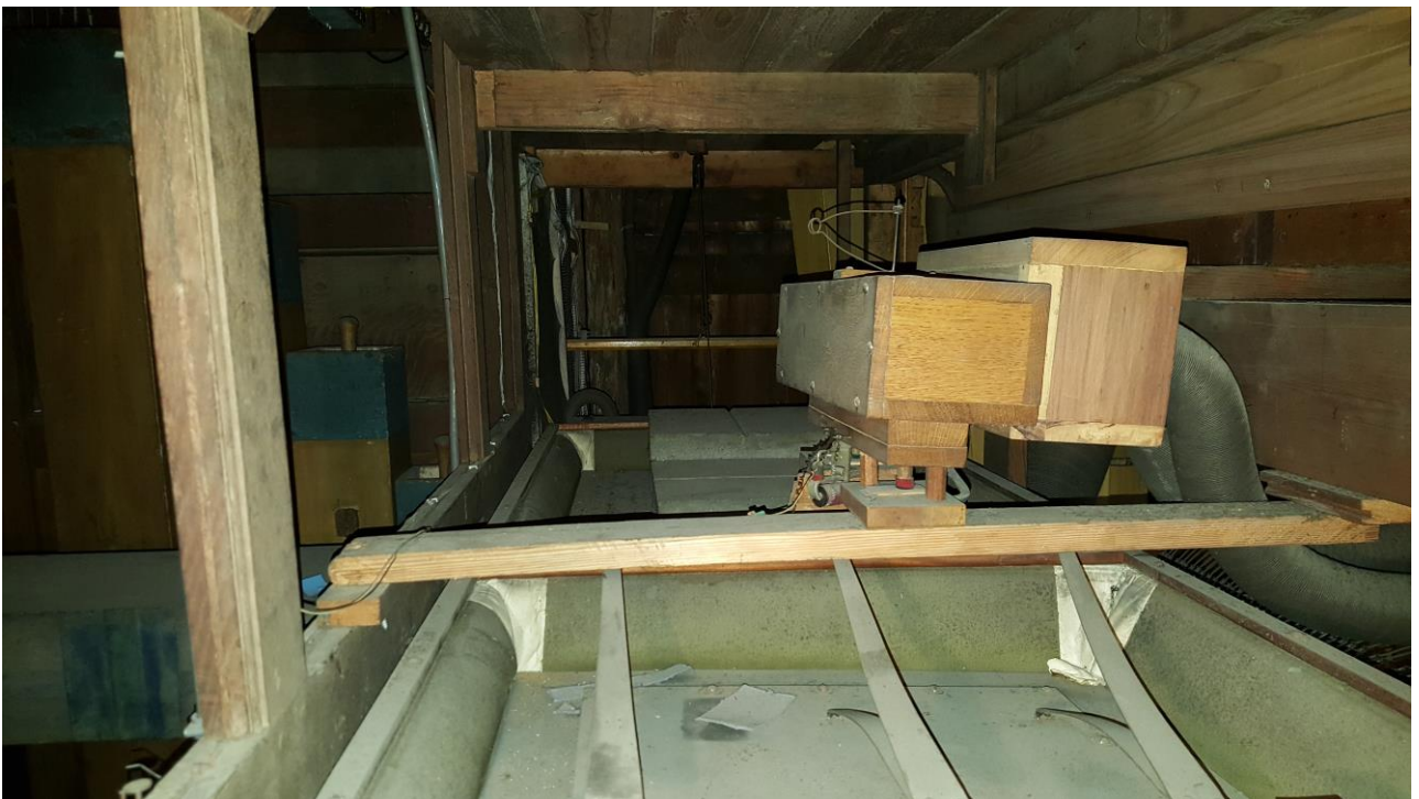
2 "Schwimmerbalgen" onder de loopplank tussen hoofdwerk en Reciet: leder licht gebarsten in de rechte hoek
