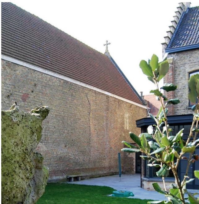
De noordgevel van de Sint-Jozefszaal. De gevel toont een overlangse barst. De schade aan de gevel werd na de Eerste Wereldoorlog met een rode baksteen hersteld. De bakgoot toont talrijke lekken.
