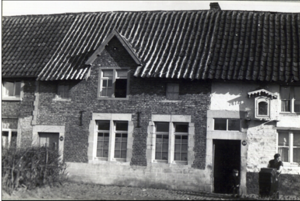
Geen goot aanwezig
