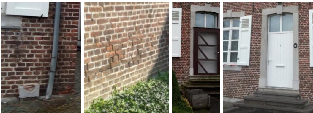
afvoer keuken in voorgevel beschadiging voet regenpijp
