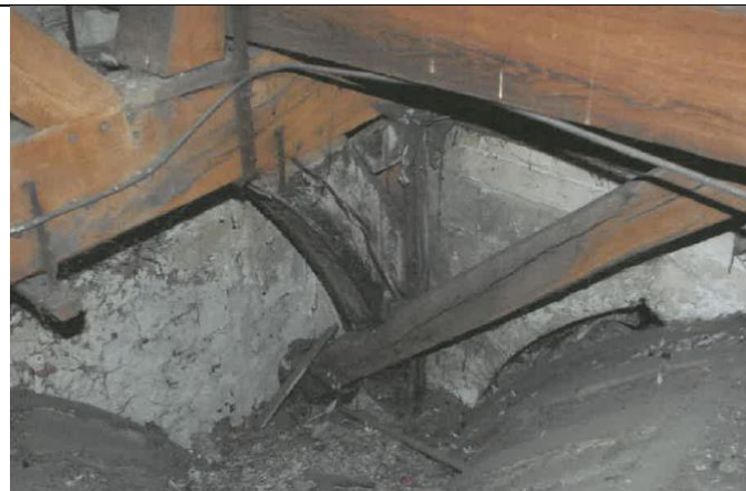
Aantasting door uitwerpselen duiven (bovenwerk plafond)
