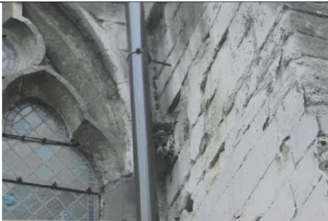
Scheuren tussen steunberen zijbeuken en zijmuur
