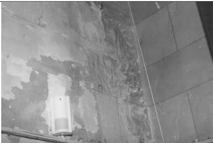
Aantasting imitatie zandsteen (binnenmuur) door vocht
