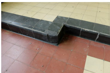
Verschillende types schade aan tegels
