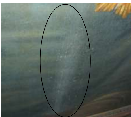
Opstuwing van de verflaag.
