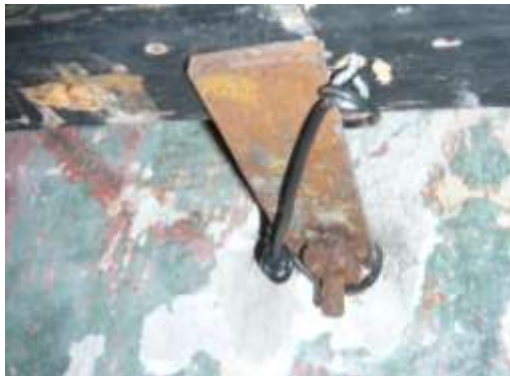
Roestig anker aan de onderzijde.
