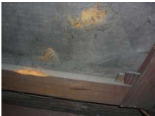
Het spieraam is verzwakt. Het doek is plaatselijk ondeskundig hersteld.
