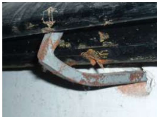
Beschadiging ter hoogte van een anker.
