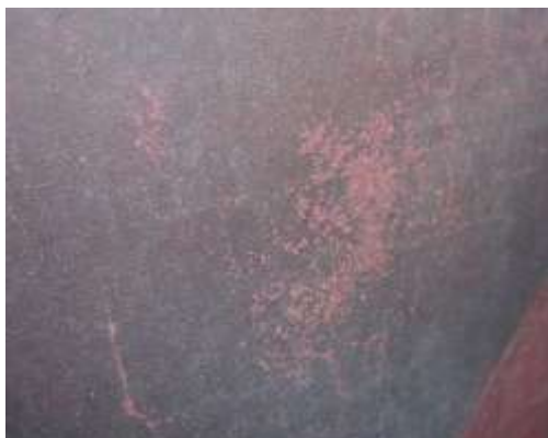
Afschilfering van de verflaag.
