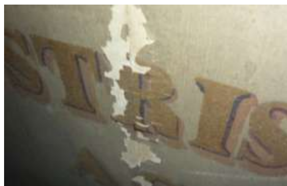
Afschilfering van de verflaag.
