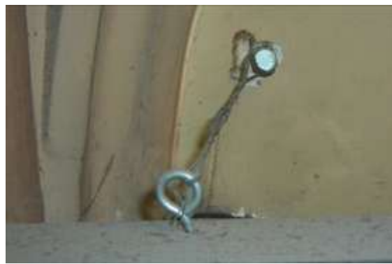
De bevestiging bovenaan is slordig en kan verbeterd worden.
