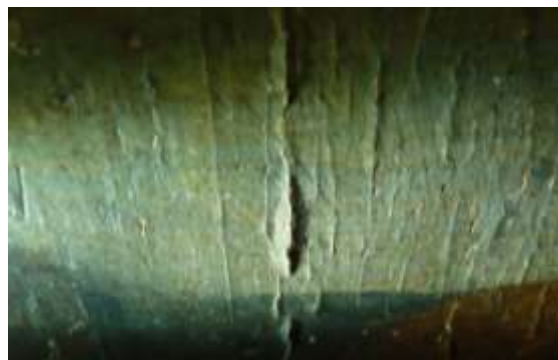
Opstuwning van de verflaag.
