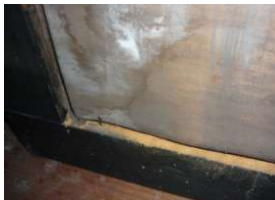
Boormeel aan de achterzijde, afkomstig uit de triplexplaat.
