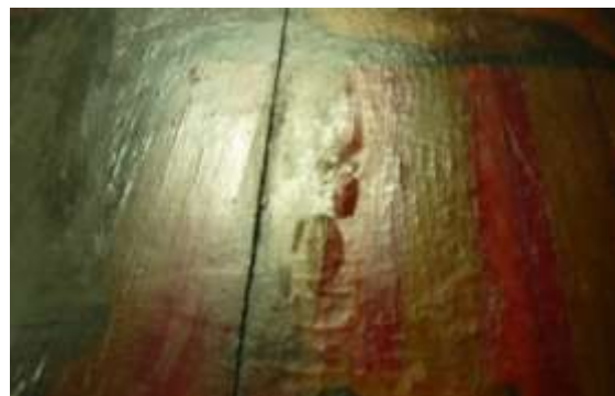
Open voeg en opstuwing van de verf.
