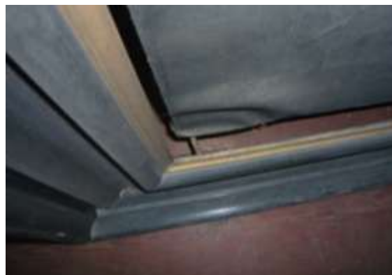
Het doek zit onvoldoende gehecht in de lijst en golft vanuit de hoeken.
