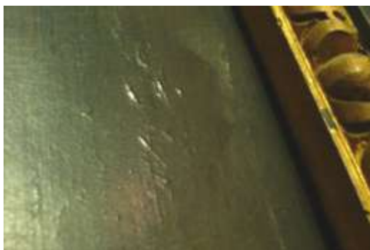
Opstuwing in de verflaag.
