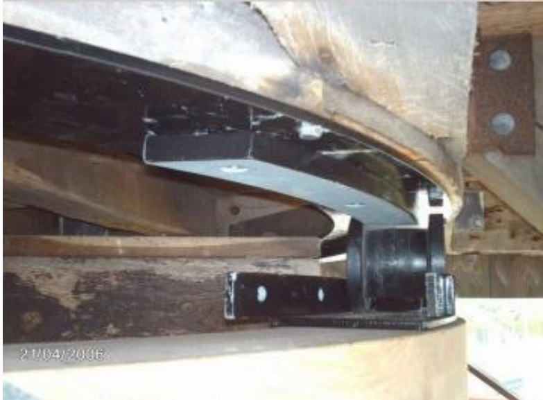
Het in 2006 geplaatste rollenkruierwerk (© R. Hillewaert, Nieuwpoort).
