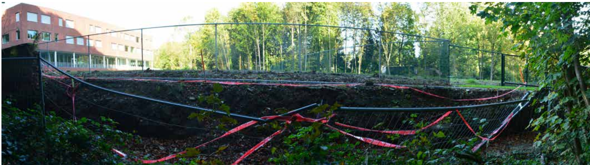
Figuur 81: Parkmuur vanaf CAPA-gebouw tot Leuvensepoort met ontbrekend deel achter Britisch School (Bron: terreinwerk SumResearch )
