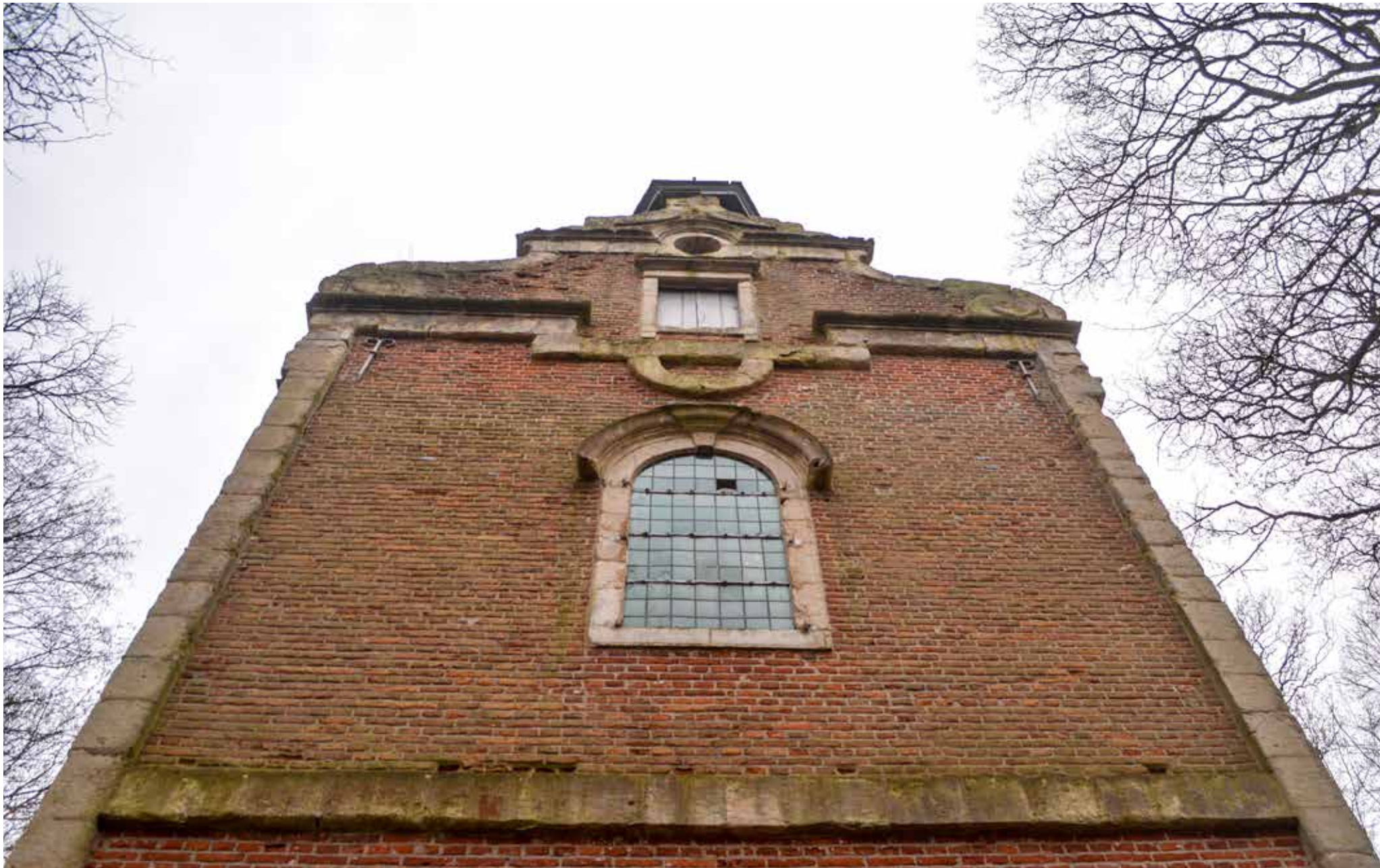
Figuur 279: Schade exterieur Sint-Hubertuskapel (Bron: terreinwerk SumResearch)
