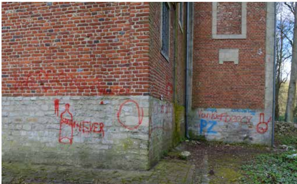
Figuur 280: Schade exterieur Sint-Hubertuskapel (Bron: terreinwerk SumResearch)
