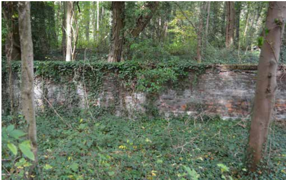
Figuur 146: Impressie muur kant Paleizenlaan met aanzienlijke beschadigingen (Bron: terreinwerk SumResearch)
