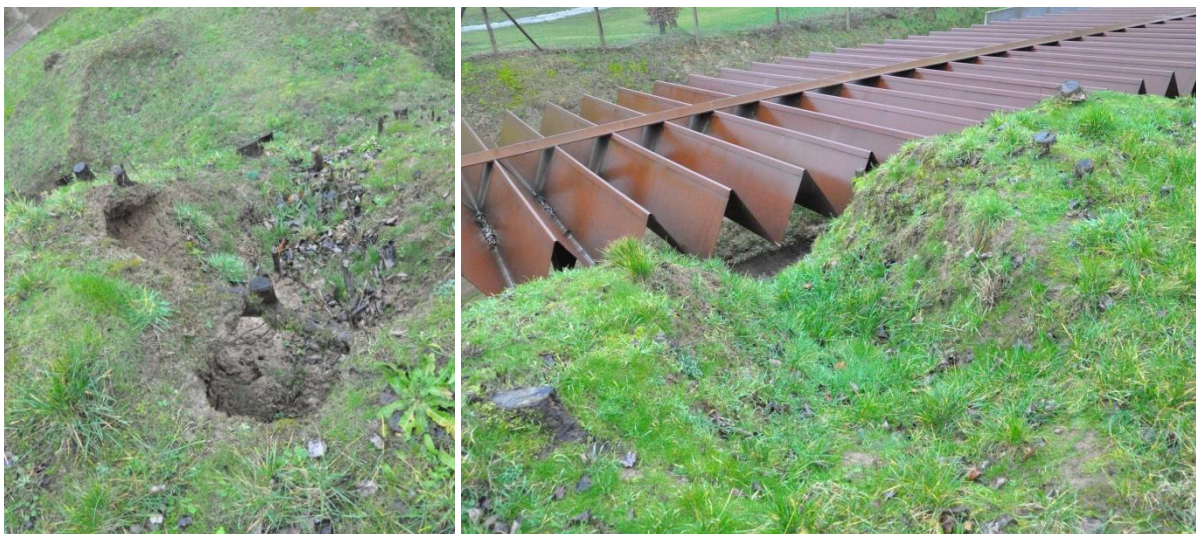
Bermravijntjes in berm naast infiltratiegracht in grondmassief achter de leemwand (© Mowa, 25.01.2018)
