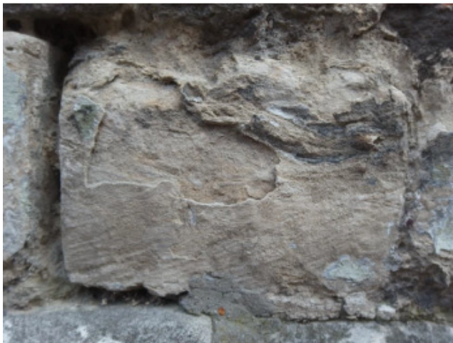
Afb. 46: Detail Gobertangesteent in de zijgevel met loszittend afschilferend korstje waarop zowel de schuine beitelslagen als de horizontale gelaagdheid nog waar te nemen zijn. 50 ©Dusar M., Rapport Spiegelhuis Zoutleeuw. Natuursteen in het parement, p. 5.
