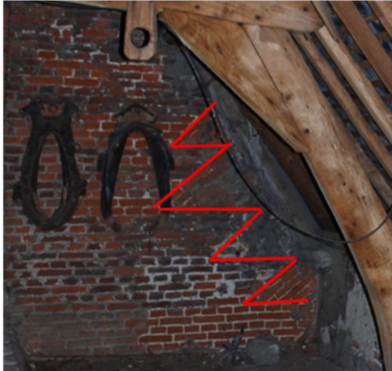
Afb. 152: Detail zolder – gevel burens langs de koerzijde met aanduiding van de vlechting.
