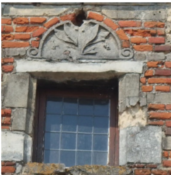
Afb. 40: Detail zolderraam: verschillende steensoorten rond het raam met diverse schadepatronen en vervangsteen met blekere patina, mogelijk behorend tot de groep der Savonnièrestenen ©Dusar M., Rapport Spiegelhuis Zoutleeuw. Natuursteen in het parement, p. 11.
