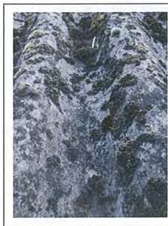
Foto: afschilferende en bemoste vezelcementen golfplaten
