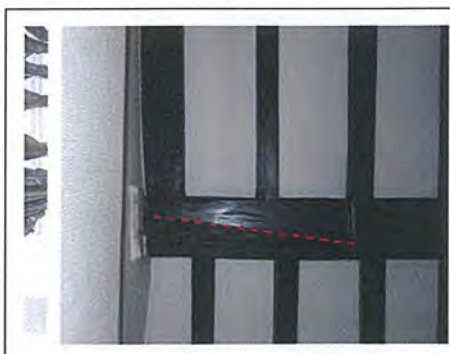
Foto: ondersteunende sleutel van de moerbalk vertoont een diepe scheur die de halve diepte van de balk betreft.
