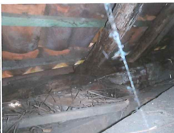
Ingerotte muurplaat en keervoet halverwege het westelijk dakvlak
