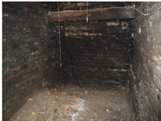
▲ foto 3.18: shouwkanaal op zolder
