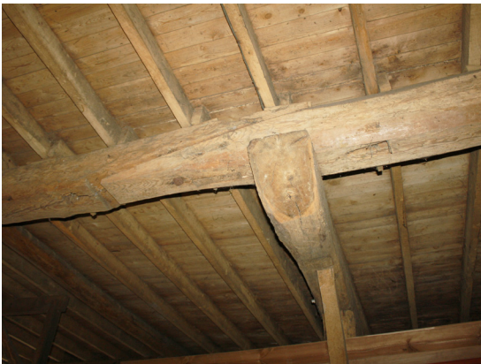
▲ foto 2.19: stalstructuur, ontbrekende kolom
