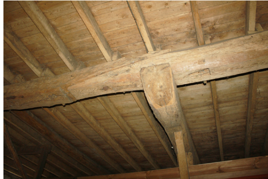
▲ foto 3.6: woonstalhuis doorbuigende dekbalk en zuidelijke moerbalk
