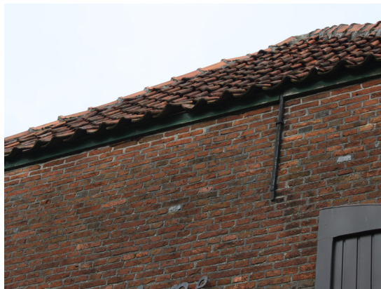
▲ foto 2.12: op verschillende plaatsen is een groenblauwig geverfde boordplank zichtbaar
