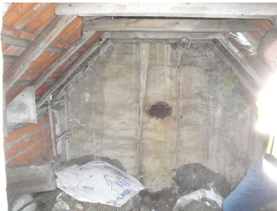
▲ foto 3.34: bakhuis ruimte boven oven
