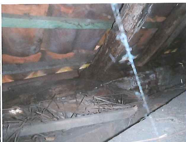
Ingerotte muurplaat en kepervoet halverwege het westelijk dakvlak
