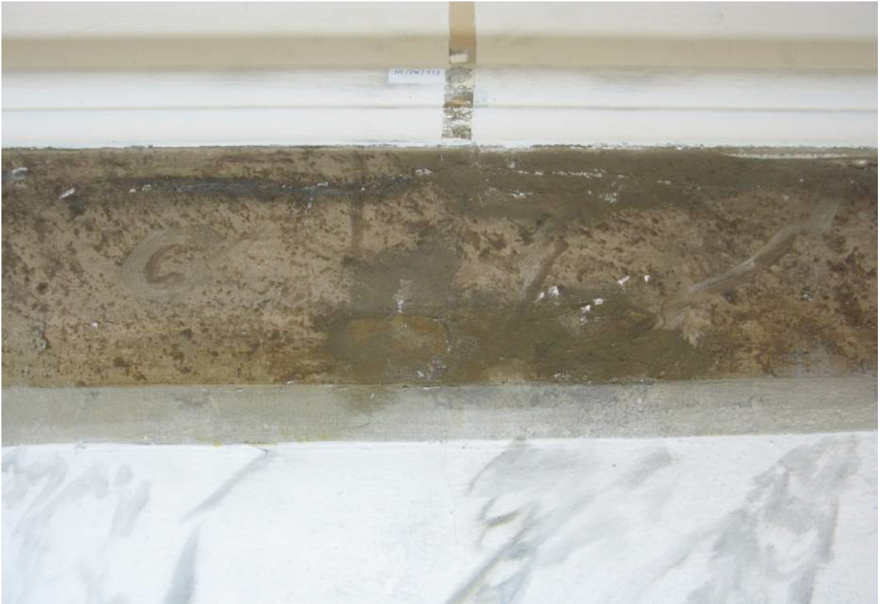
Noordtransept, bovenaan: Slordig uitgevoerde retouches.
