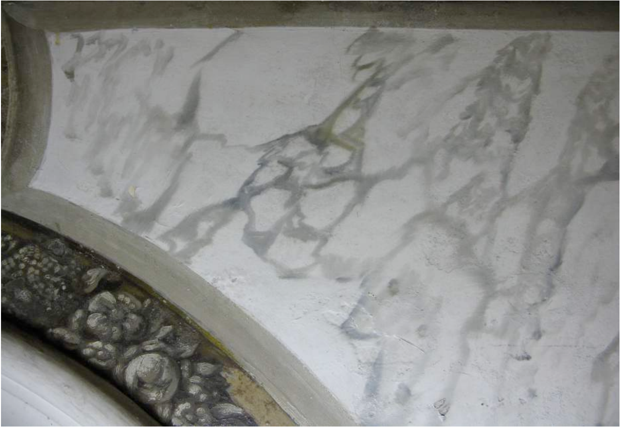
Noordtransept, bovenaan rechts van tondo: Afschilferende zones.
