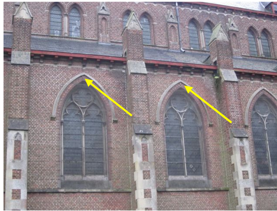
Figuur 7: (herstelde) scheuren in metselwerk ter hoogte van bovenzijde ramen
