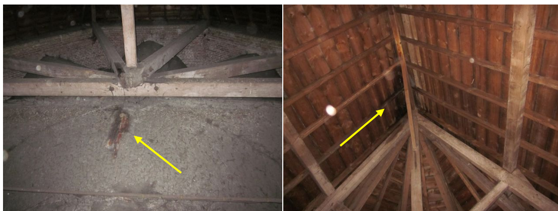
Figuur 13: Vochtinfiltratie via dak ter hoogte van gewelf boven altaar.
