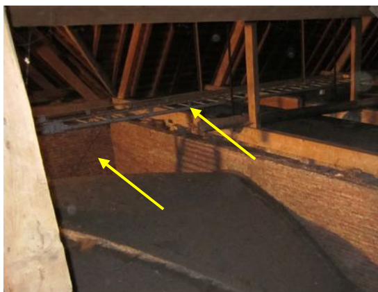
Figuur 6: scheur in rib van gewelf ter hoogte van samenkomende dakvlakken
