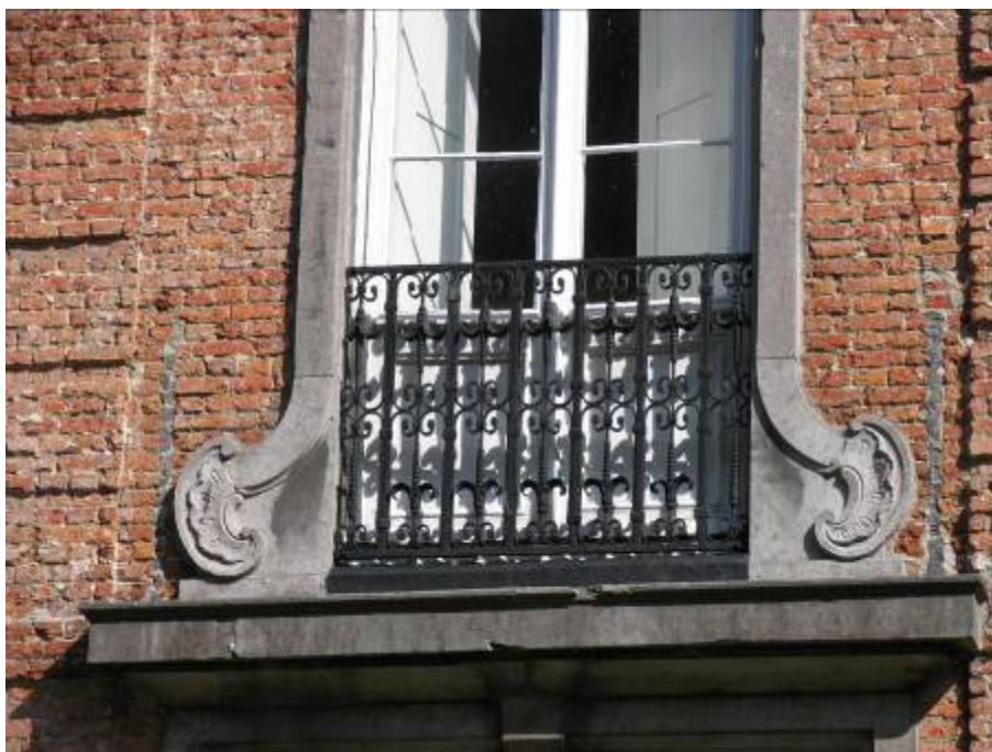
Fig. 11: zuidvleugel, centraal venster op de eerste verdieping. Links en rechts van de omlijsting zijn zwarte lijnen zichtbaar, sporen van een vroegere, bredere balustrade.
