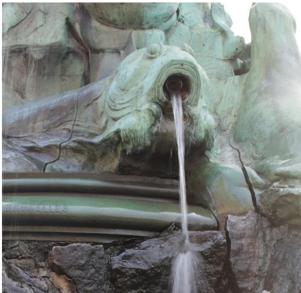
Figuur 30. Openstaande naden onderaan de basis, situatie 2017
