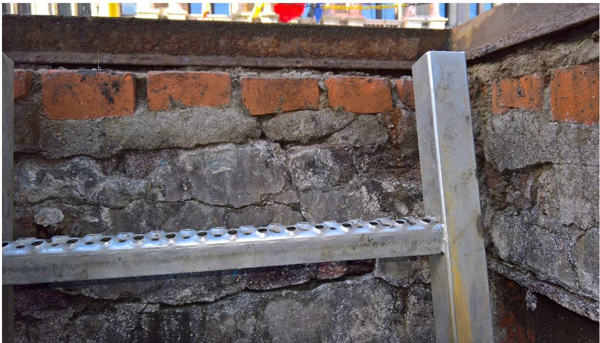
Figuur 56. Toegang kelder met waterterugloop. Barsten en lacunes in cementbepleistering, eveneens losse bakstenen.
