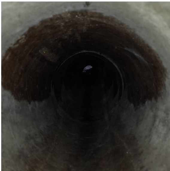
Figuur 69. Afvoerbuis van binnenuit gezien – achteraan is opening waarneembaar, de buis is niet verstopt.
