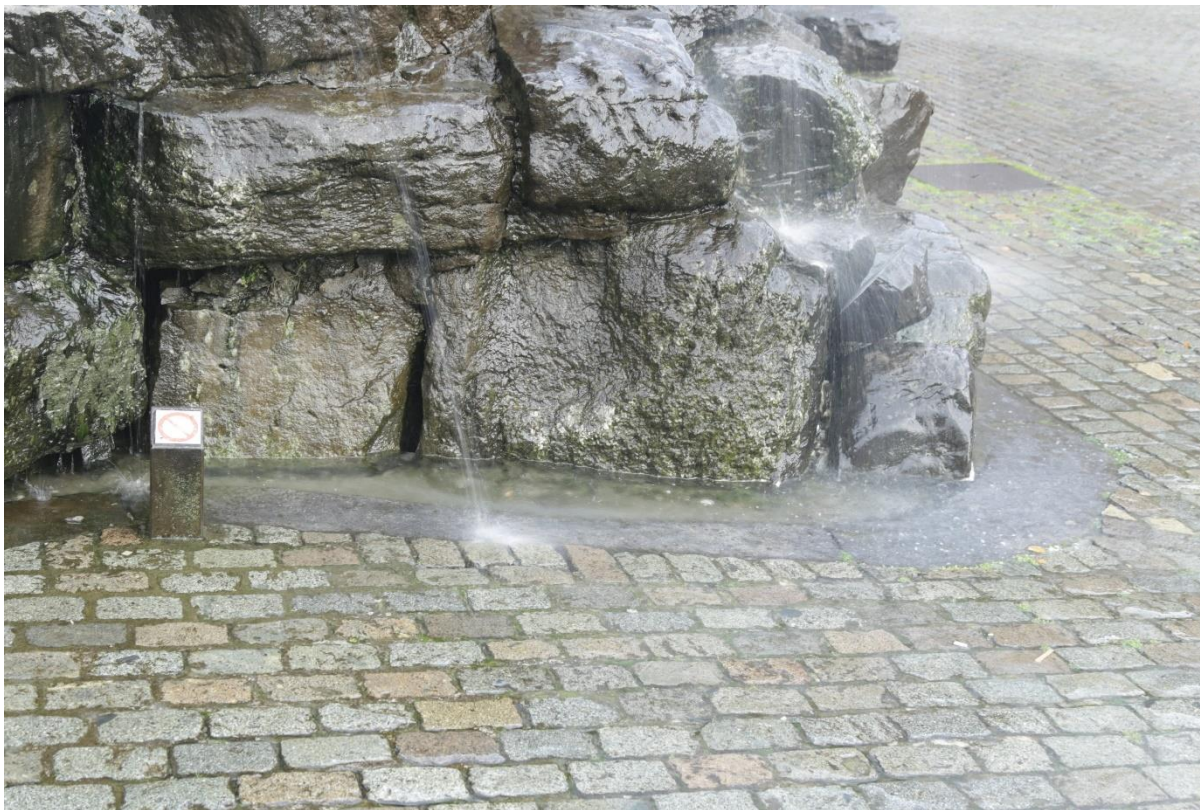
Figuur 43. Door de verstopping van de afvoerleidingen ontstaan grote plassen onderaan de rotspartij.
