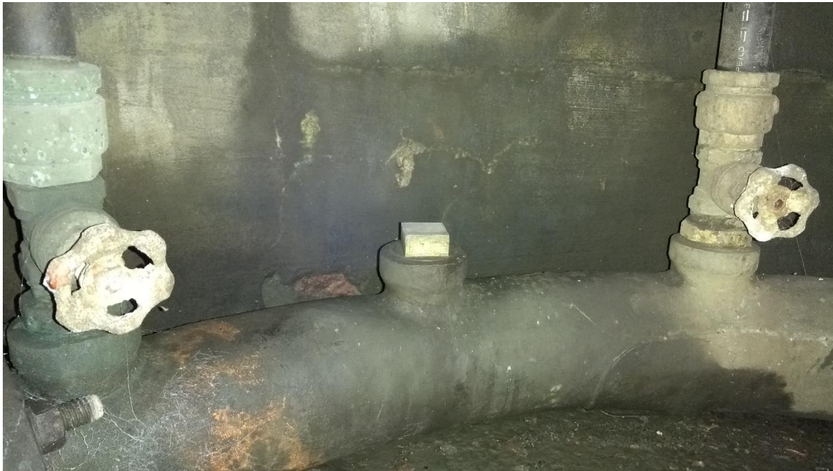
Figuur 60. Detail van de hoofdcollector. Een van de 16 voorziene punten is niet aangesloten. In totaal zijn er dus 15 regelbare leidingen.
