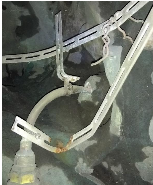
Figuur 66. Bevestigingspunten van de kunststof waterleidingen in slechte staat.
