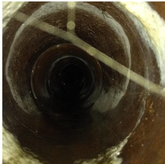
Figuur 70. Afvoerbuis van binnenuit gezien – halverwege de buis is deze volledig verstopt met vuil en afval.
