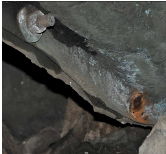
Figuur 29. Openstaande naad langs de binnenzijde, situatie 2010
