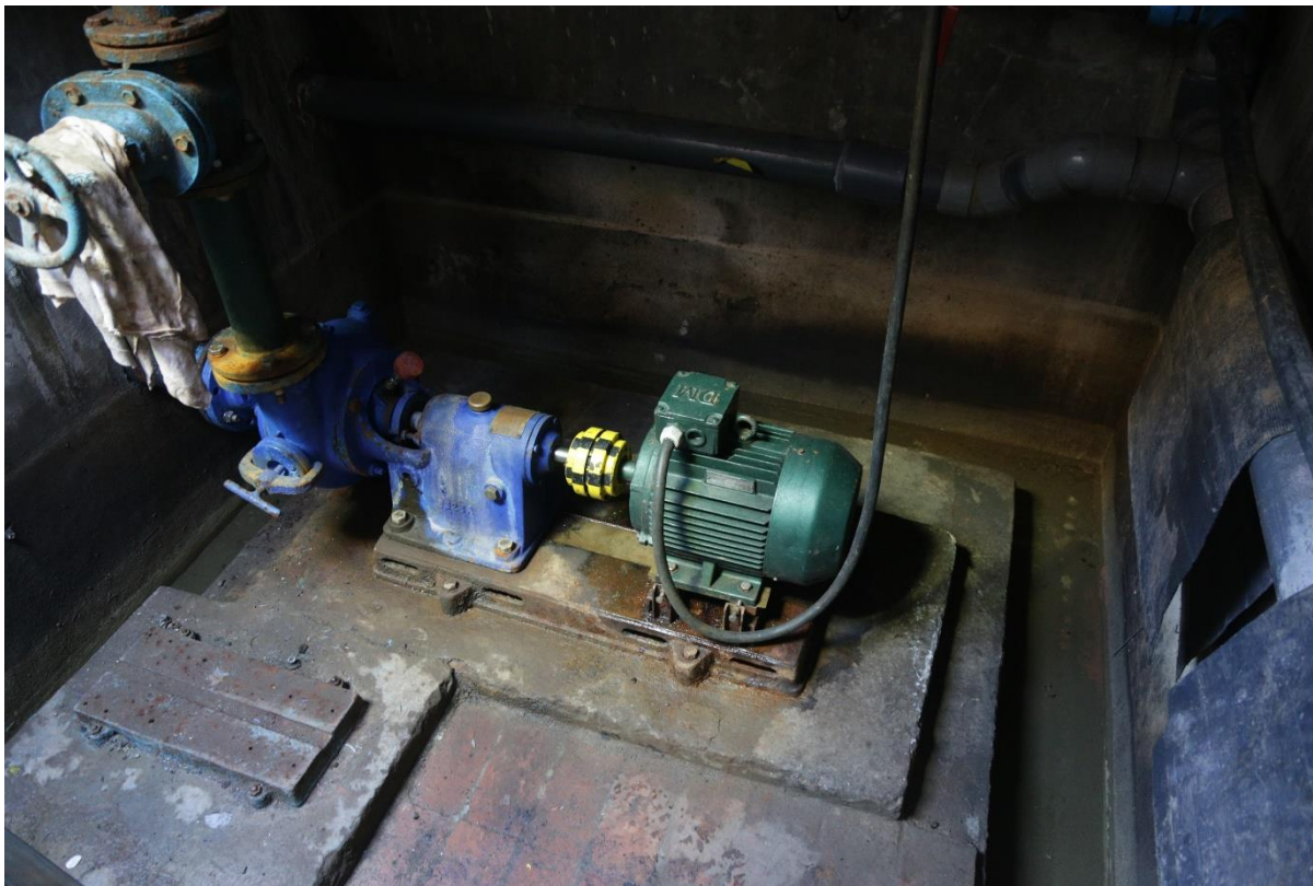
Figuur 67. Algemeen beeld van de pompinstallatie met elektromotor.
