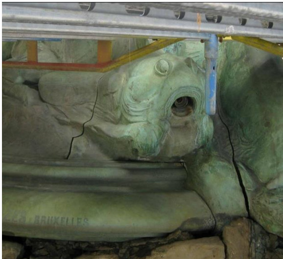
Figuur 28. Openstaande naden onderaan de basis, situatie 2010
