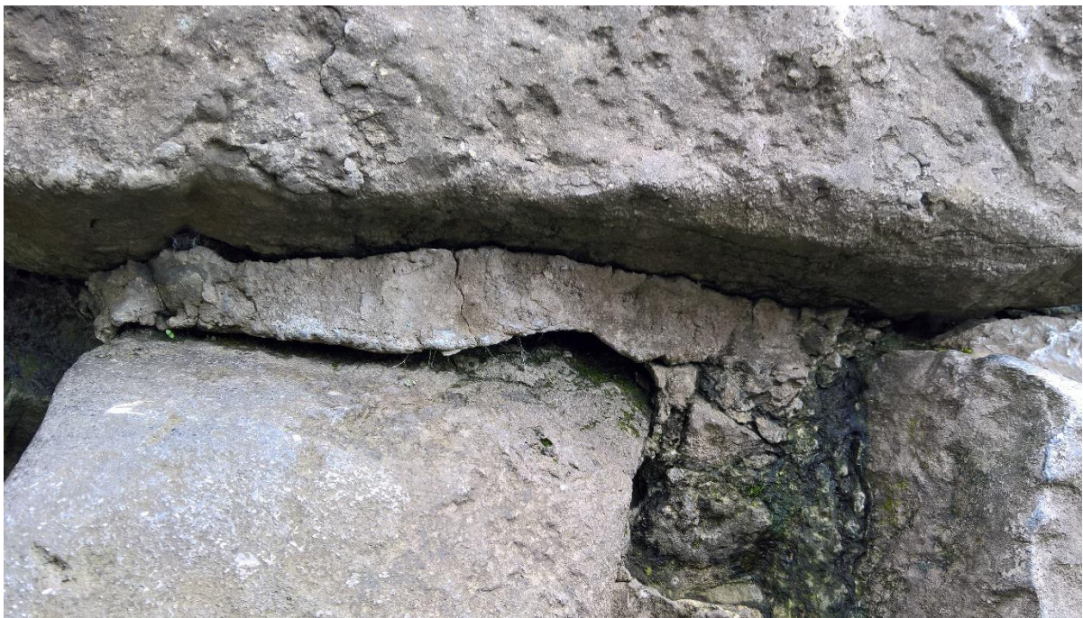
Figuur 45. Loszittende voegen bedreigen de stabiliteit van sommige rotsblokken.
