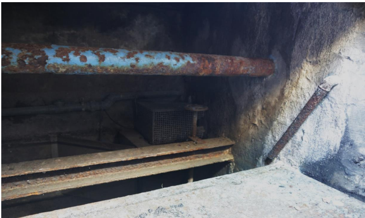
Figuur 58. De aanvoerleiding wordt vanuit de pompkelder door de muur naar de terugvoerput geleid. Door de constante hoge luchtvochtigheid is deze in zeer slechte toestand. Achteraan in de hoek ziet men de filter voor het water terug naar de pomp wordt geleid.
