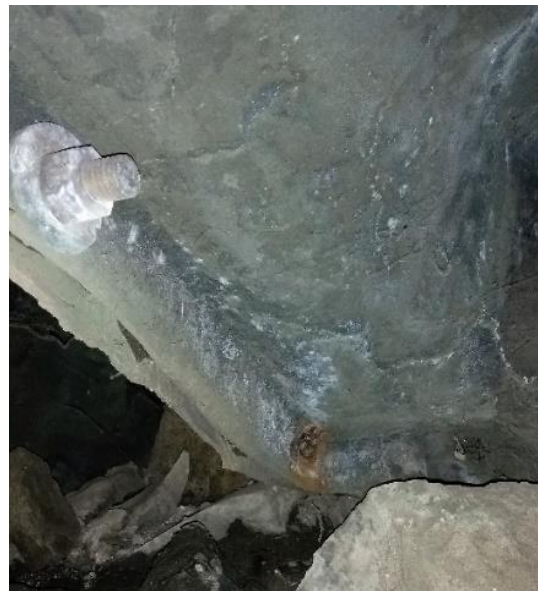
Figuur 31. Openstaande naad langs de binnenzijde, situatie 2017
