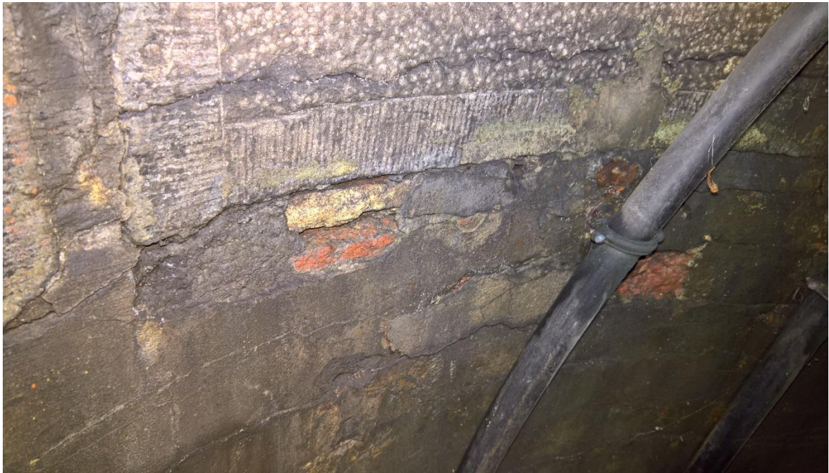
Figuur 55. Wand van de put, ter hoogte van de aansluiting met de arduinen kraagsteen. Barsten en lacunes in cementbepleistering.
