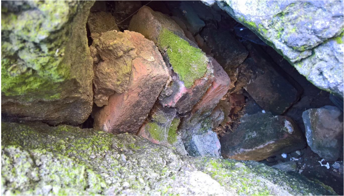
Figuur 46. De rotspartij is op sommige plaatsen ondersteund door gestapelde bakstenen. Ook deze zitten echter op veel plaatsen los.
