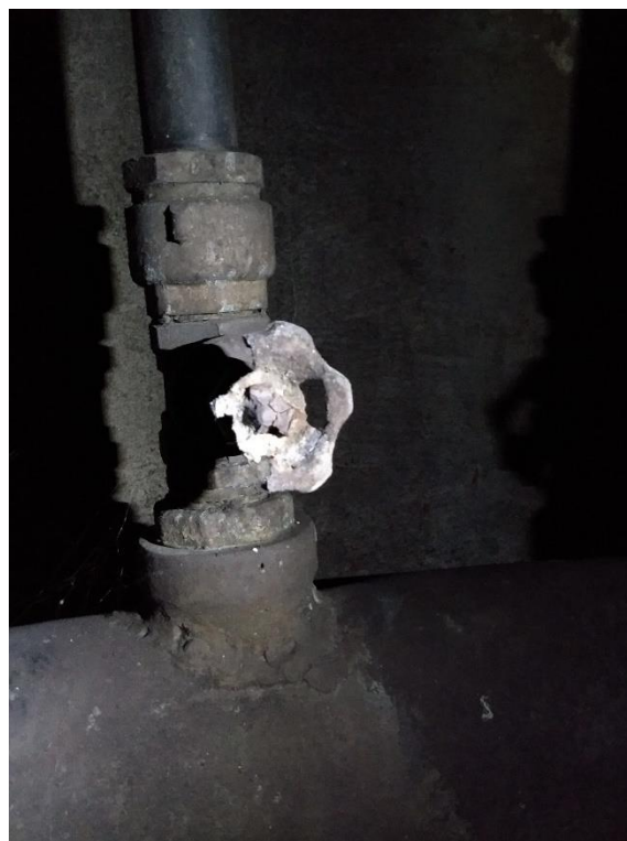
Figuur 62. Zorgwekkende toestand van de regelkranen.
