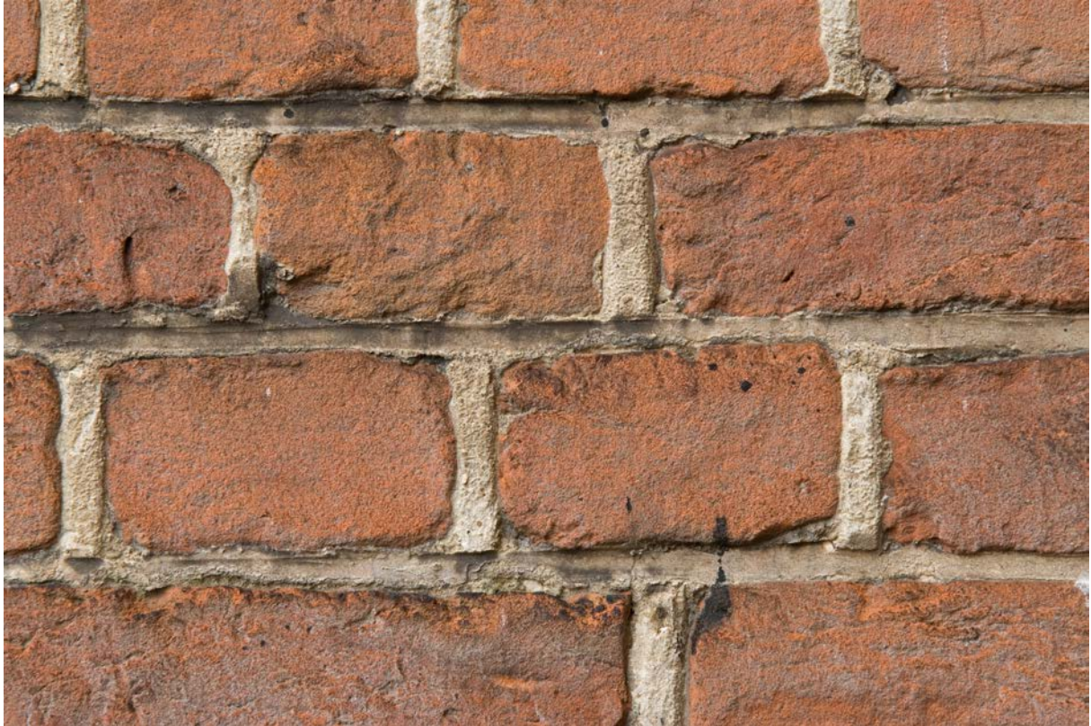
Voegwerk met opliggende stootvoegen.
