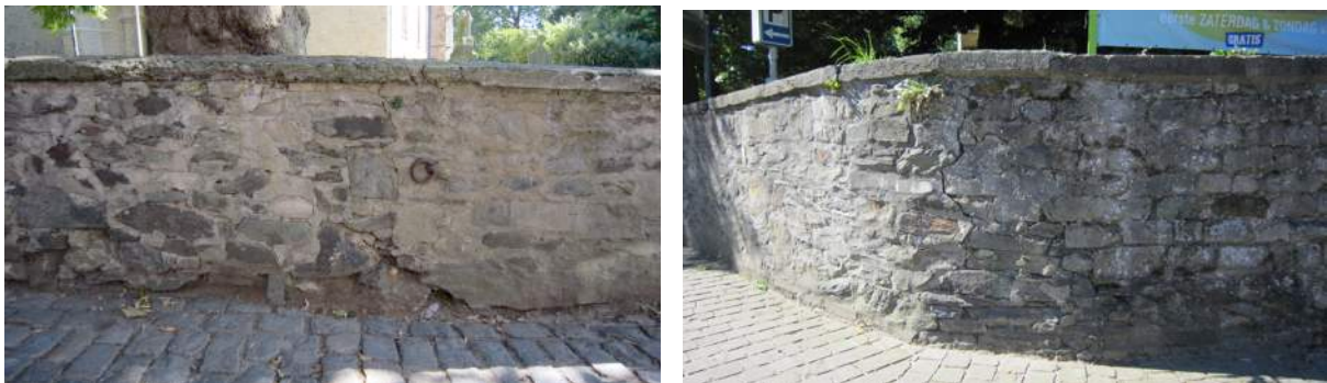
Afbeeldingen 126 en 127. Enkele schadebeelden: ontbrekende stenen, verticale barsten.
