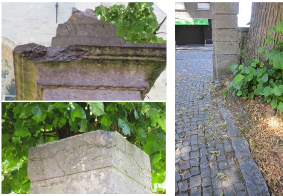
Afbeelding 131, 132 en 133. Pijler en beschadigde en ontbrekende deksteen en (bol-) bekroning aan de westelijke toegang, concurrentie tussen boom en pijler.
