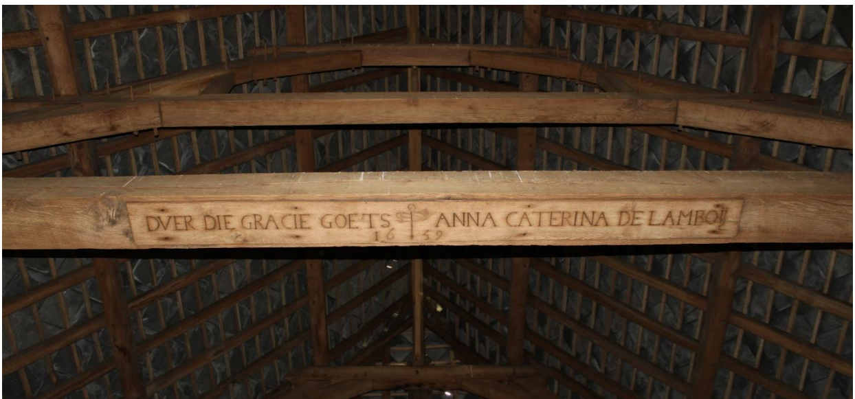
De kapconstructie is gedateerd en gesigneerd met de naam van de opdrachtgeefster.
