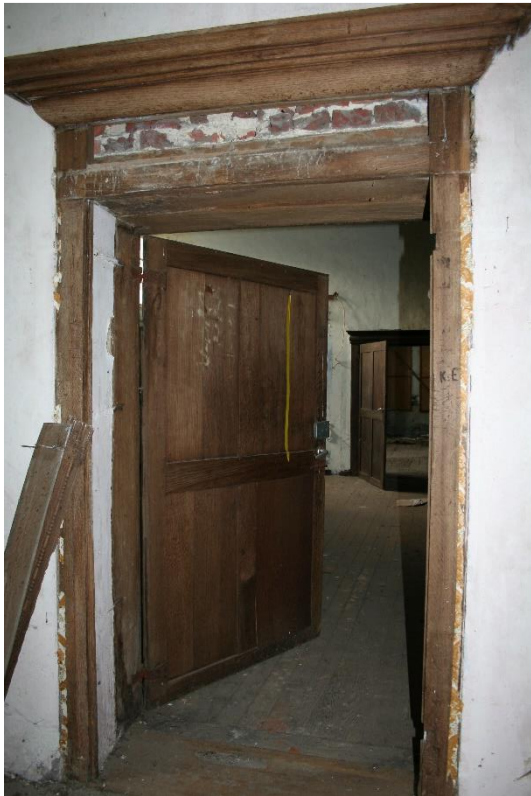
Oorspronkelijke beschadigde houten deurkader.
