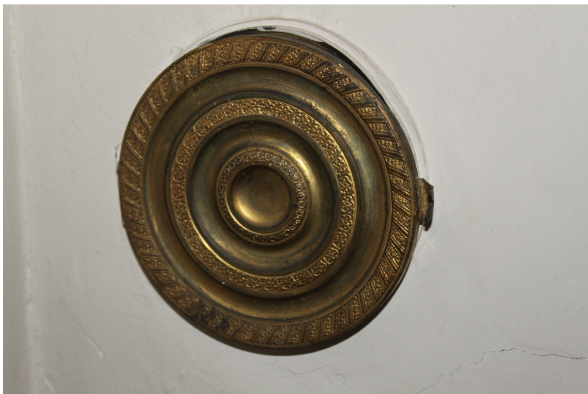
Foto 65: +0, eetkamer, detail uitblaasmond verwarmingssysteem
