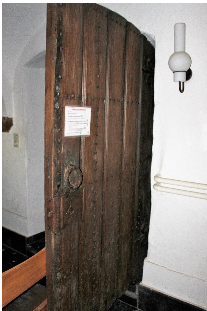
Foto 109, -1, kelder, opgeklampte deur
