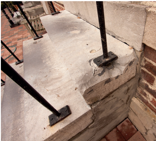
Afb. 036. detail schade aan linkertrap
