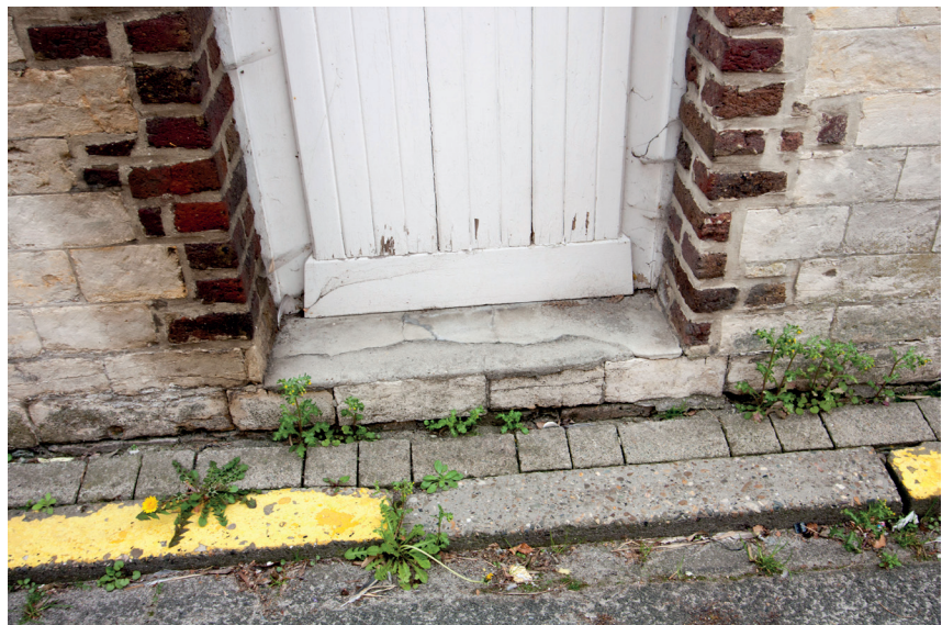
Afb. 055. gecementeerde dorpel die reeds gebarsten is
