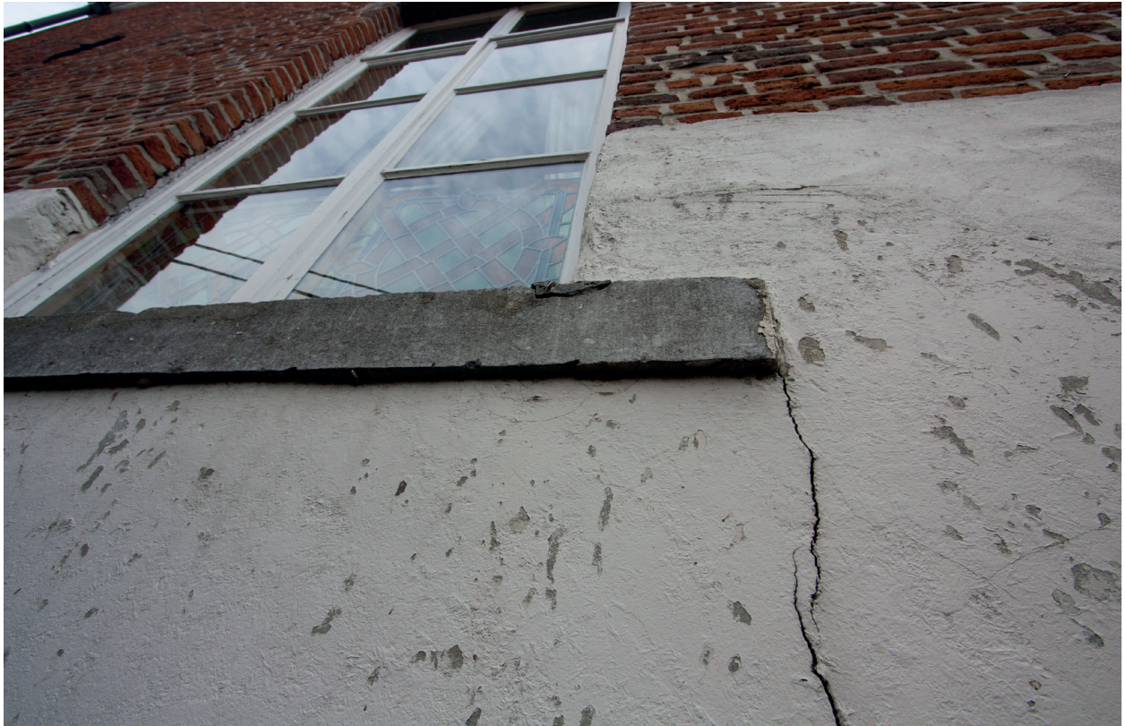
Afb. 030. scheur in de cementering
