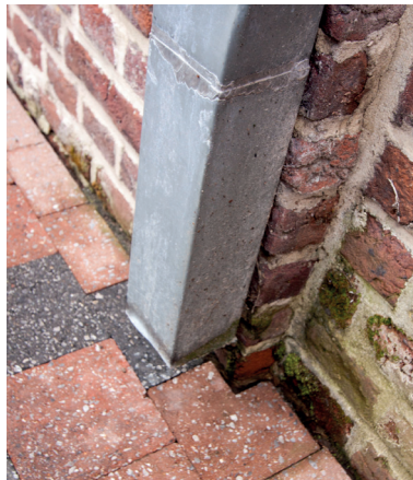
Afb. 044. regenwaterafvoer niet aangesloten op riolering
