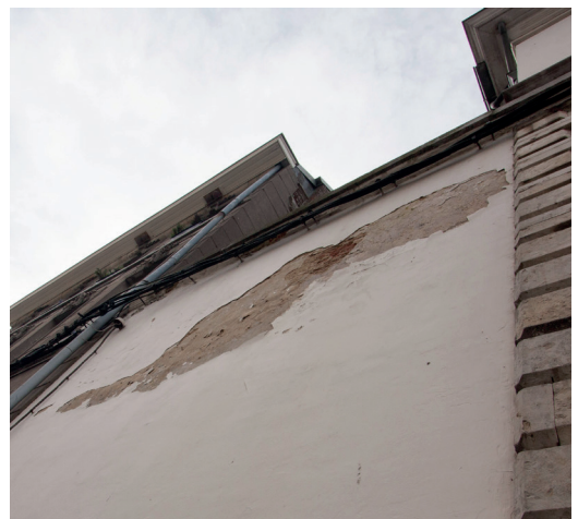
Afb. 025. beschadigd gevelpleisterwerk en verweerde kroonlijst
