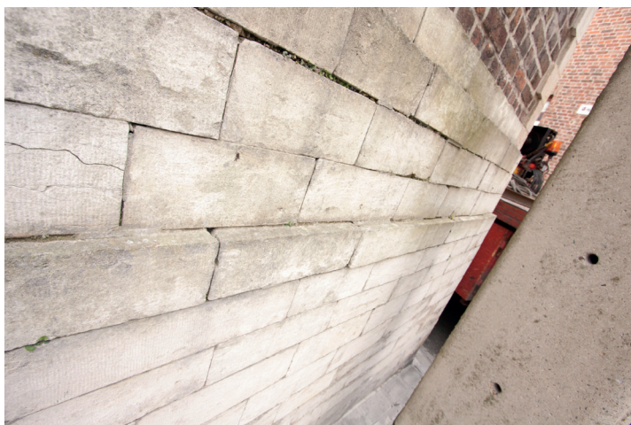
Afb. 026. uitgesleten voegen en loszittende blokken witte natuursteen thv de tuinmuur
