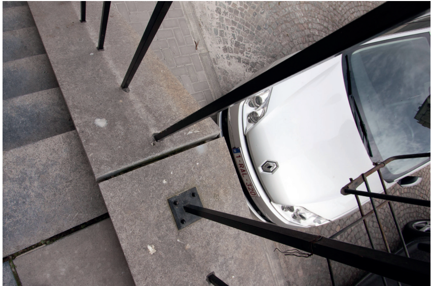
Afb. 021. uitgevallen voeg thv blauwe hardstenen deksteen en tussen de tegels
