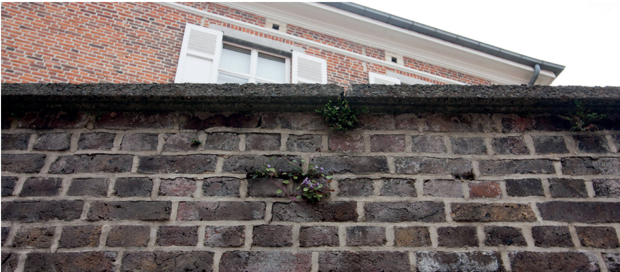
Afb. 053. uitgespoelde voegen tussen de dekstenen, verweerd voegwerk tussen de bakstenen en begroeiing
