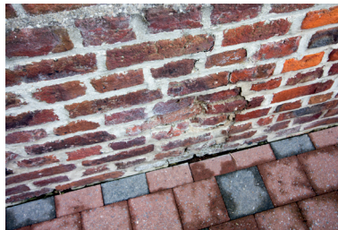
Afb. 043. ontbrekende voeg tussen opgaand metselwerk en buitenvloer
