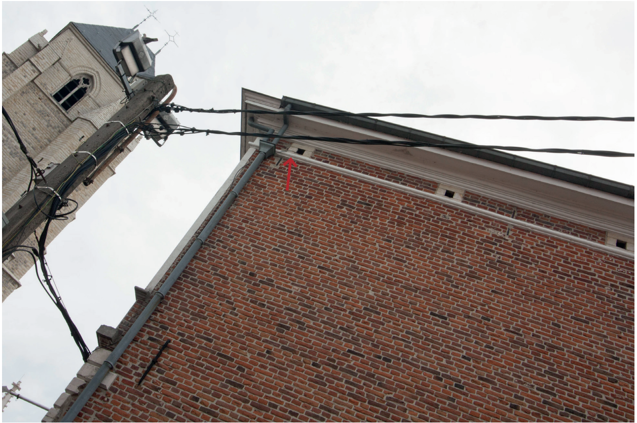
Afb. 029. hanggoot aan de rechterzijgevel en kabel in het stellinggat
