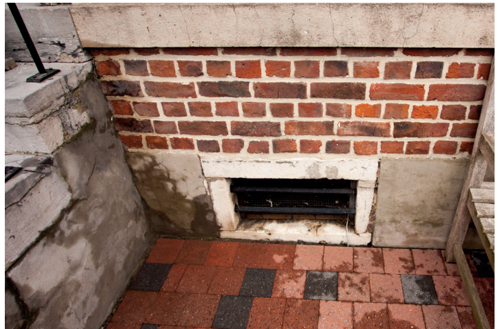
Afb. 037. beschadigingen aan de cementering en zicht op keldergat
