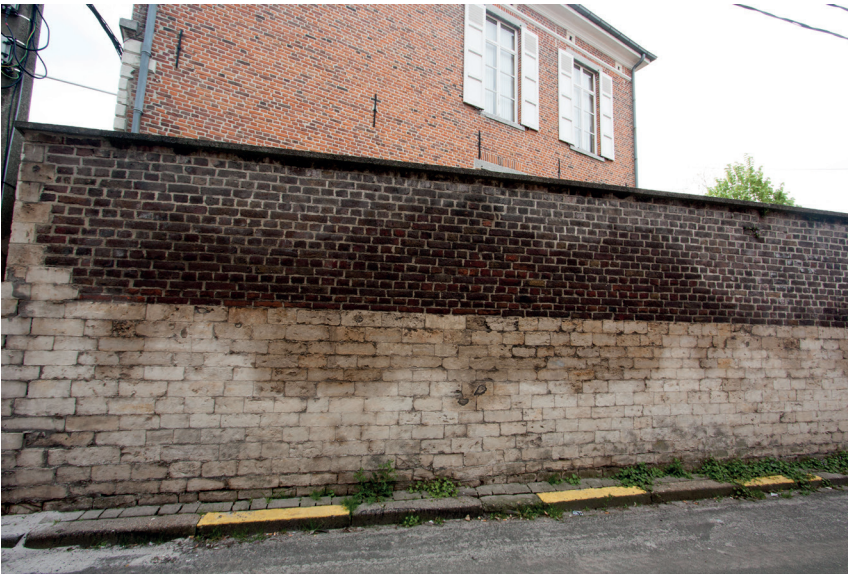
Afb. 051. vochtplek thv de tuinmuur
