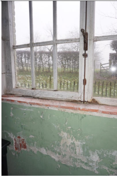
Foto 46 : schade tgv waterinfiltratie in atelier
