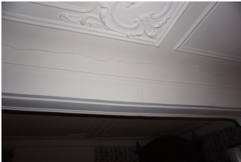
Foto 48 : barsten in plafond salon
