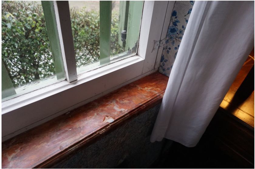
Foto 47 : schade aan marmerschilering op tabletten
