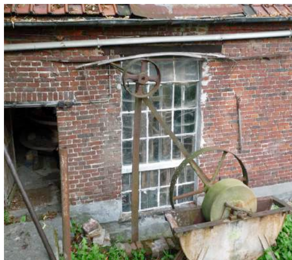
foto 31- stalen raam in achtergevel
