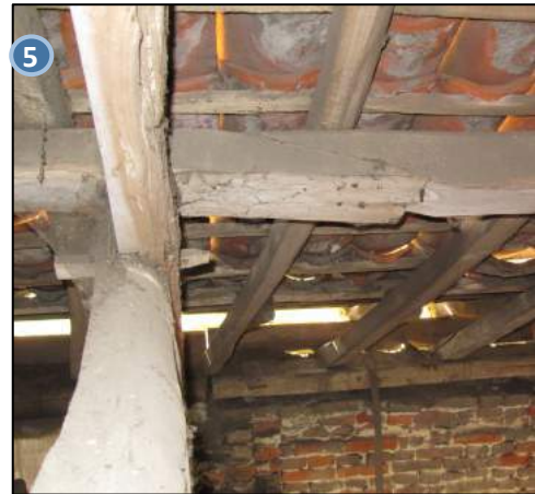
Foto 42 - onderbroken gording overdekte doorgang
