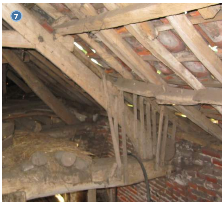
Foto 50 - onderbroken gordingen en oude gevelbekleding op spant
