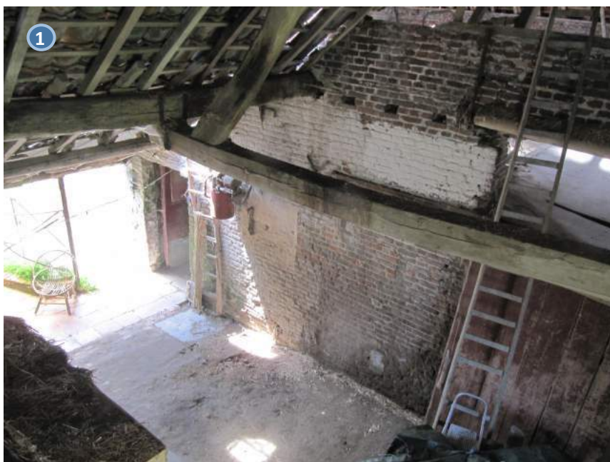
Foto 54 - plaasterwerk en gaten in de muur getuigen van vroegere aanbouw aan de schuur
