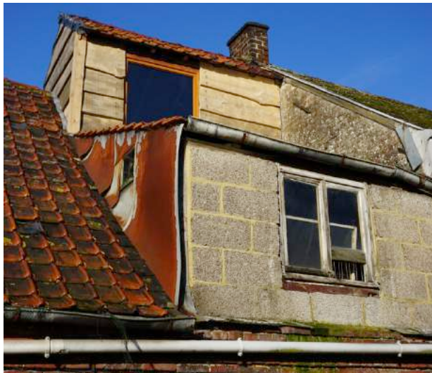
foto 39 - duivenhok in oostelijk dakvlak
