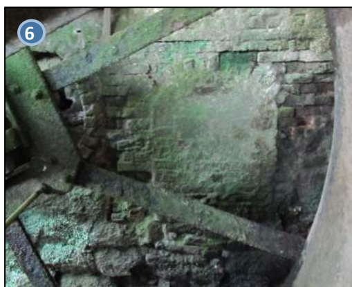
Foto 27 - oud asgat in de watergevel
