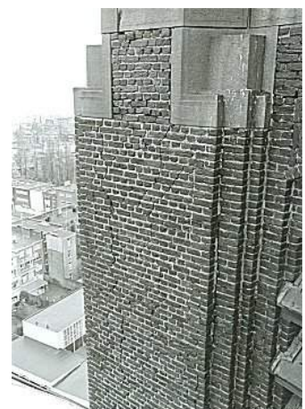
5 december 1974. Bovenste gedeelte wordt bouwvallig en moet worden afgebroken.
