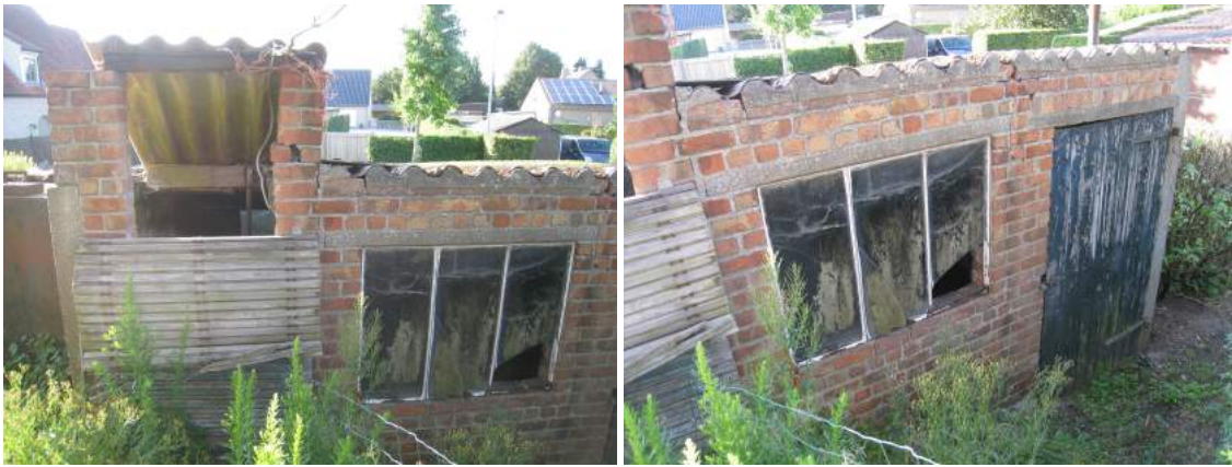
afb. 3.41 © Monumentenwacht West-Vlaanderen APB BIJGEBOUW MET DIESELMOTOR
