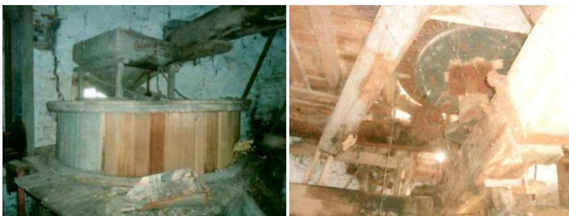
afb. 3.14 © Maarten OSSTYN, het West-Vlaams Molenblad Jaargang 32/1, 2016-1 links EEN NIEUW STEENKOPPEL, AFKOMSTIG VAN EXCELSIOR IN BELLEM ( AALTER ), OP EEN HOUTEN HALFZOLDER rechts HET ONDERSTE DEEL VAN DE KONING STEUNT OP DE IJZEBALK, VERANKERD AAN BEIDE ZIJDEN MET MEERDERE ZIJBALKEN
