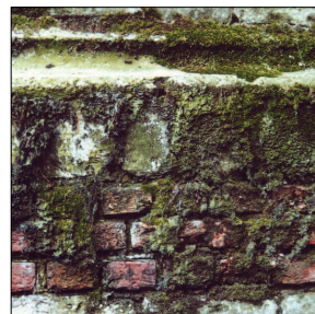
Sterk uitgespoeld voegwerk met nat metselwerk het gevolg: de ideale ondergrond voor mosgroei en algen.
