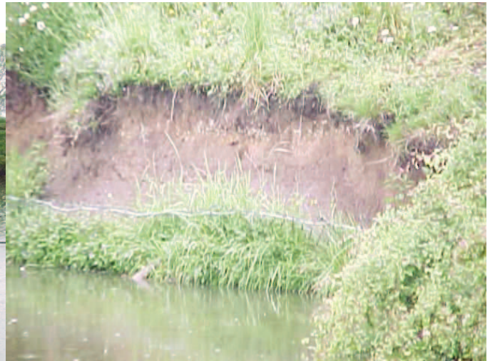
Foto 25: Detail afkalving dijk
