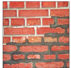
Onverstandig herstel veroorzaakt niet enkel esthetische schade maar eveneens schade aan de baksteen.
