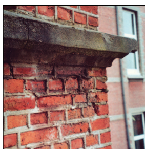
Schade door gebreken aan de druiplijst.
