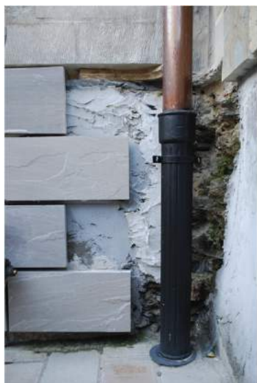
afvoerbuys koper, standpijp gietijzer
