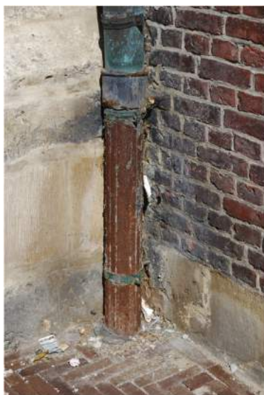
standpijp in gietijzer
