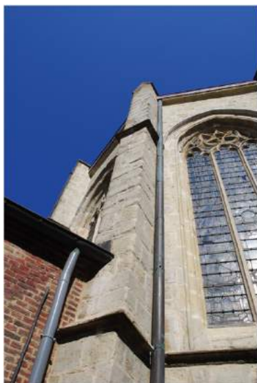
afvoerbuizen koper en pvc
