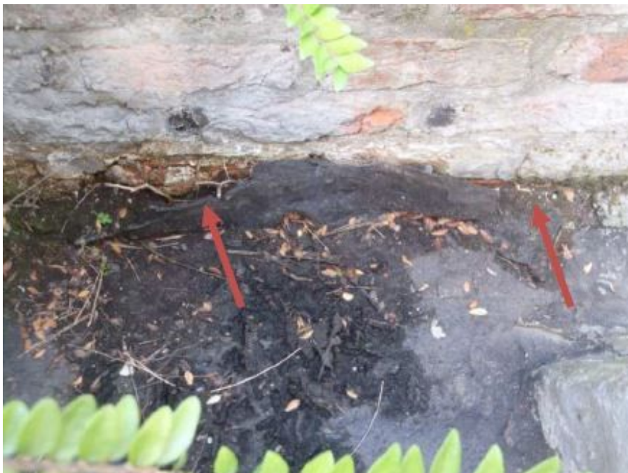
Afb. 37: detail van bitumen op de bovenzijde van de borstwering
