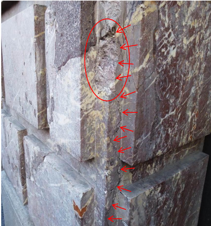
Figuur 1: Rode pijlen duiden een discontinuïteit in de compacte kalksteen aan (foto van de zuidwestgevel). Een deel van de steen is reeds afgevallen (rode cirkel).
