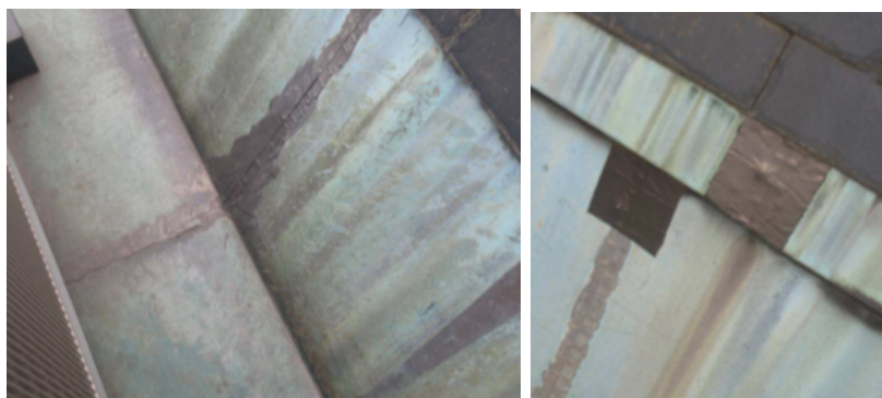
Afbeelding 70: zicht op de gootnaden van een zakgoot. De naden zijn gedicht met een reparatiecoating (foto Origin)
