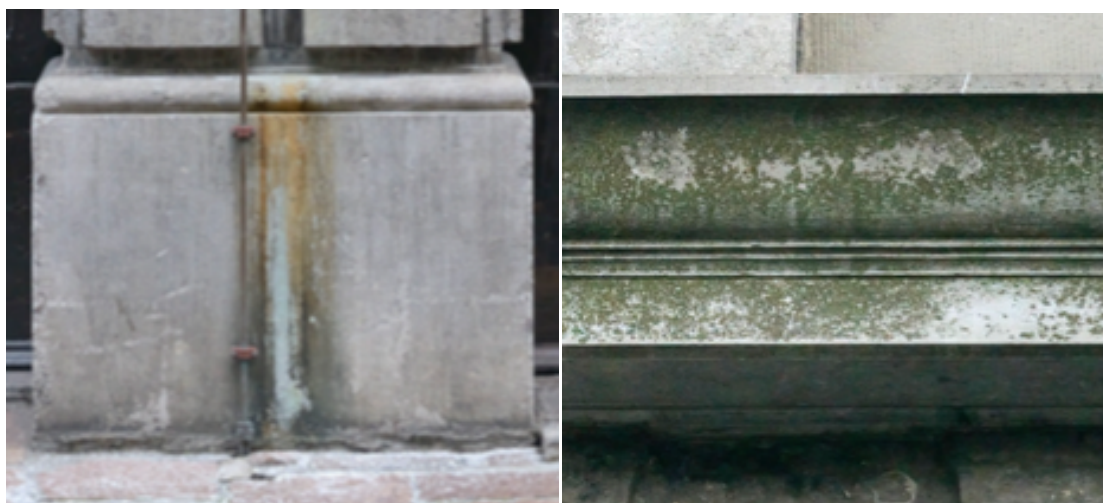
Afbeelding 19: corrosie van de bliksemafleider
