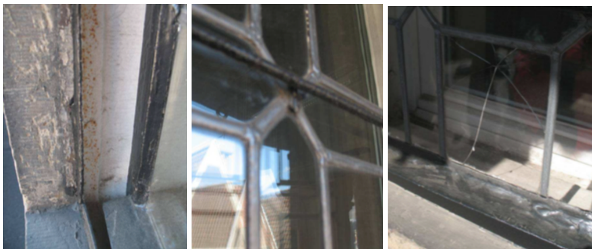
Afbeelding 40: de stalen ramen op de 2e verdieping zijn licht roestig (foto Origin)
