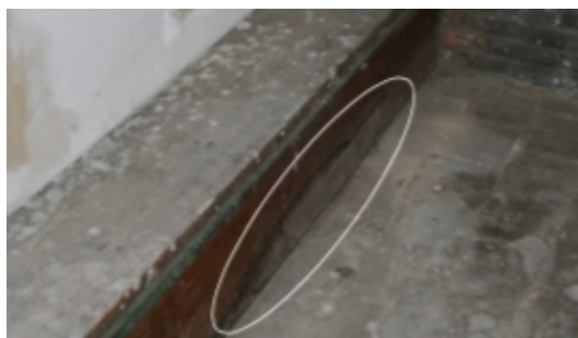
Afbeelding 82: zicht op de Keulse goot in kamer 03.13. Op het hout zijn vochtatfekeningen zichtbaar welke wijzen op lekken in de goot (foto Origin)
