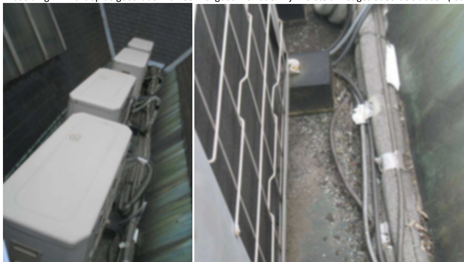
Afbeelding 72: zicht op de airconditioning die opgesteld staat in de zakgoten ( foto Origin)
