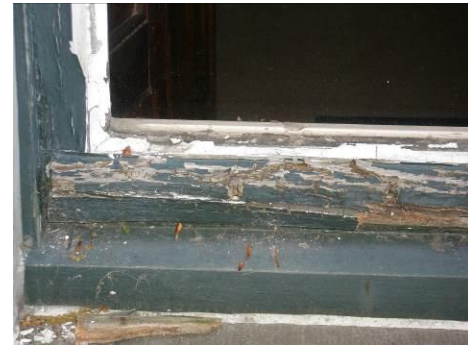
Toestand buitenschrijnwerk gelijkvloers
