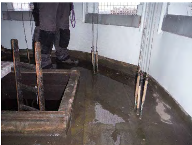
WATER BLIJFT STAAN IN LANTAARN VAN TOREN - FOTO MONUMENTENWACHT
