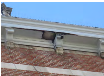
INGEROTTE GOOTCONSTRUCTIE OOSTVLEUGEL - FOTO MONUMENTENWACHT
