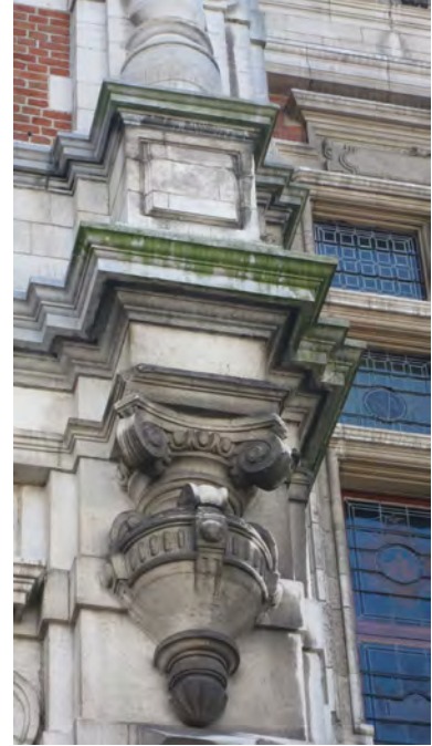
AANBRANDLAAG OP ORNAMENTEN VAN DE VOORGEVEL VAN HET MONUMENT
