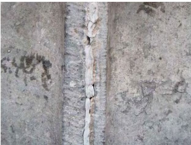
SLECHTE HERSTELLING MET ELASTISCHE VOEGKIT VAN DE MUURBEKRONING AAN DE RONDGANG VAN DE TOREN - FOTO MONUMENTENWACHT
