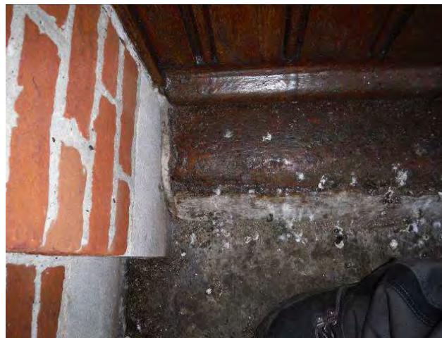
SLORDIG AANGEKIT DEURGEHEEL TER HOOGTE VAN DE RONDGANG AAN DE TOREN - FOTO MONUMENTENWACHT
