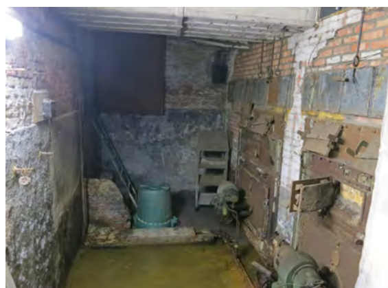
ONDERTUSSEN VERDWENEN VERWARMINGSINSTALLATIE IN HET DISTRICTSHUIS VAN BORGERHOUT
