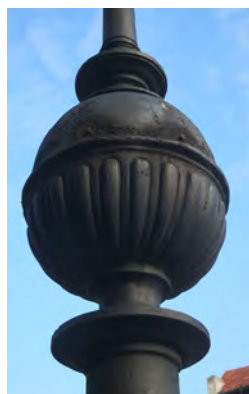
DETAIL LANTAARN WAAR ROESTSCHADE KAN WORDEN OPGEMERKT
