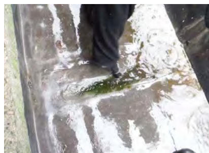
VERZAKKING GOOT TUSSEN TOREN EN ZADELDAK VOORBOUW - FOTO MONUMENTENWACHT
