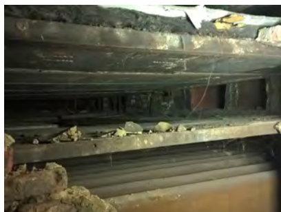
METALEN LAMELLEN INSTALLATIE BOOGAERTS
