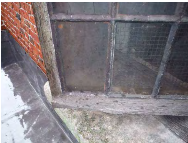
VERWEERD BUITENSCHRIJNWERK RAAM AAN ZUIDZIJDE TOREN - FOTO MONUMENTENWACHT
