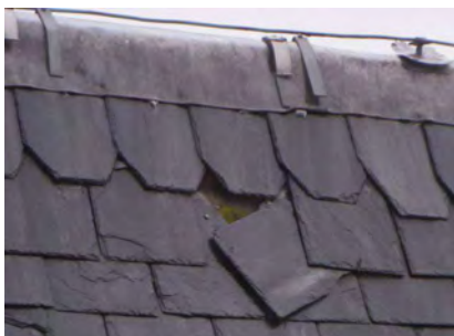
LOSGEKOMEN LEIEN CENTRAAL OP BINNENDAKVLAK NOORDVLEUGEL - FOTO MONUMENTENWACHT
