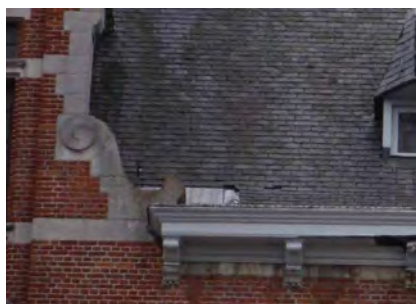
LOSGEKOMEN LEIEN BUITENDAKVLAK OOSTVLEUGEL - FOTO MONUMENTENWACHT
