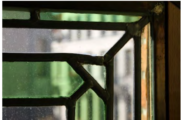
NIET DEGELIJK GEPLAATST LOODPROFIEL, TYPE 1A - PATRIMOON
