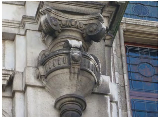
ZWARTE POREUZE KORST OP EEN GEORNAMENTEERDE DEEL VAN DE GEVEL
