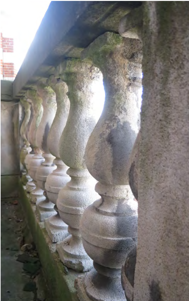
STERK VERWEERDE BALUSTERS IN SAVONNIÈRESTEEN
