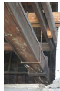
VOCHTSCHADE BINNENDAKSE GOOT ZOLDER
