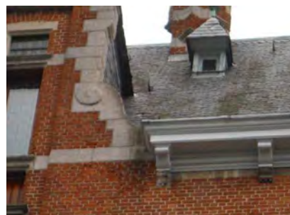
LOSGEKOMEN LEIEN BUITENDAKVLAK OOSTVLEUGEL - FOTO MONUMENTENWACHT
