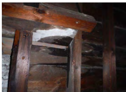
LEK TER HOOGTE MONDING OOSTTOREN ACHTERGEVEL EN DAK OOSTVLEUGEL - FOTO MONUMENTENWACHT
