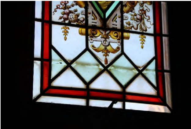
NIET TERUGGEPLAATSTE BINDROEDE TYPE 4 - PATRIMOON
