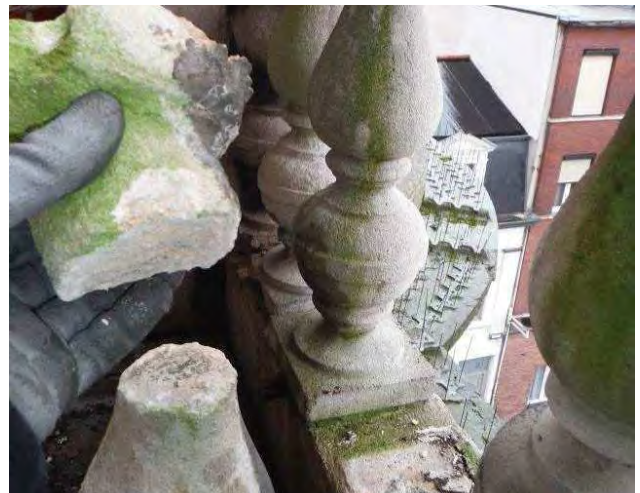
BOVEN; OPGEDRUKTE HANDLIJST VAN BALUSTRADE DOOR UITGESPOELDE LEGMORTEL, ONDER; AFGEBROKEN BALUSTERS WEGGENOMEN DOOR MONUMENTENWACHT - FOTO MONUMENTENWACHT
