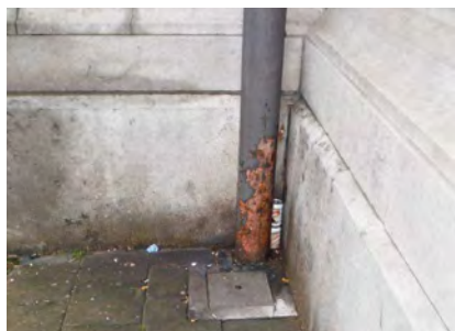
ROESTIGE GIETIJZEREN VOETSTUK REGENWATERAFVOEREN TORENS ACHTERGEVEL - FOTO MONUMENTENWACHT
