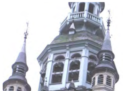
LOSGEKOMEN LEIEN KLOKVORMIG TORENDAK - FOTO MONUMENTENWACHT
