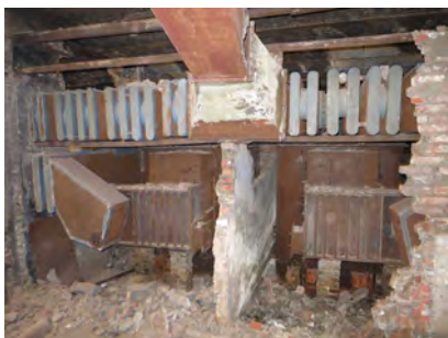
INWENDIGE TECHNIEKEN INSTALLATIE BOOGAERTS - CENTRAAL SCHOUW ROOKGASAFVOER
