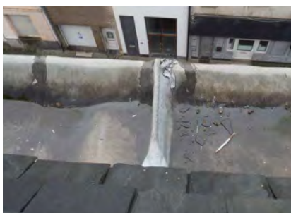
LOODBEKLEDING GESCHEURD DAK WESTVLEUGEL - FOTO MONUMENTENWACHT
