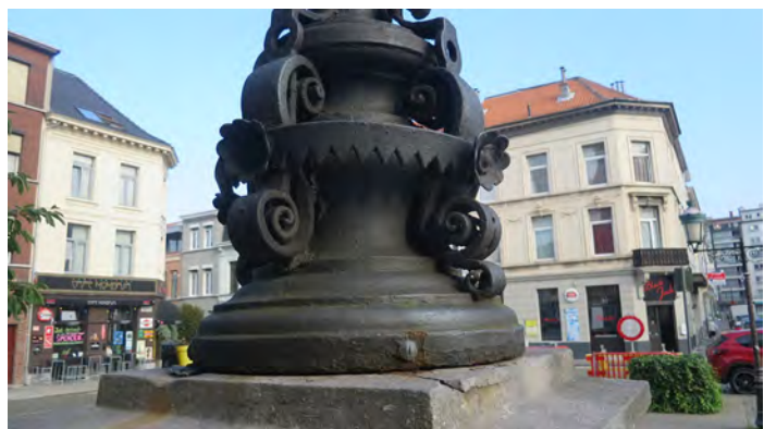
DETAIL VOETSTUK LANTAARN WAAR ROESTSCHADE KAN WORDEN OPGEMERKT
