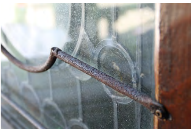
GECORRODEERDE BINDROEDE, TYPE 3 - PATRIMOON
