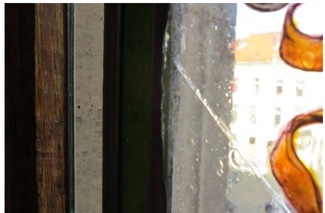
ONTBREKENDE MASTIEK, TYPE 4 - PATRIMOON
