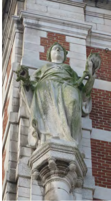
ZICHTBARE VERVUILING OP HET BEELDHOUW- WERK 'DEUGD VAN DE VOORZICHTIGHEID'
