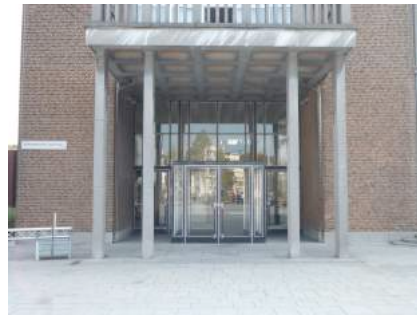
Foto inkompartij – gevelpanelen in blauwe hardsteen komen los
