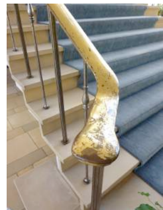
Foto metaalcorrosie trapleuning
