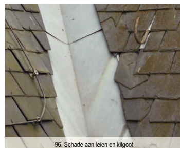
96. Schade aan leien en kilgoot
