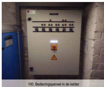
100. Bedieningspaneel in de kelder
