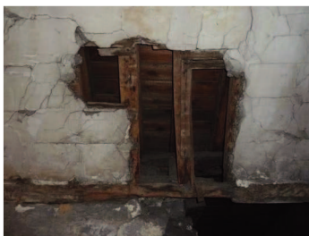
89. Lacunes in het pleisterwerk en de drager van het tongewelf
