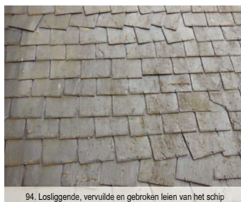
94. Losliggende, vervuilde en gebroken leien van het schip
