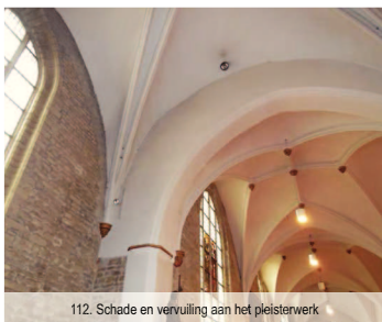
112. Schade en vervuiling aan het pleisterwerk
