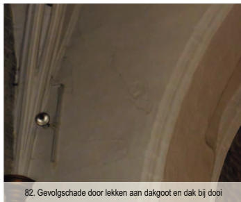
82. Gevolgschade door lekken aan dakgoot en dak bij dooi
