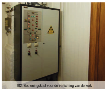
102. Bedieningskast voor de verlichting van de kerk
