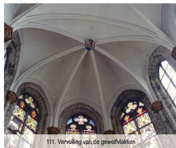
111. Vervuiling van de gewelfvlakken
