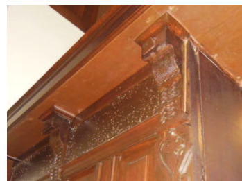
120. Schade aan houten schrijnwerk door houtborende insecten
