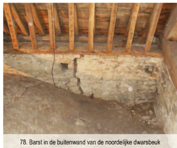
78. Barst in de buitenwand van de noordelijke dwarsbeuk
