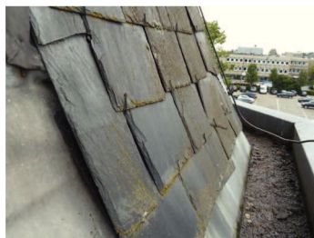
93. Dakgoot van het koor met slechte afwatering
