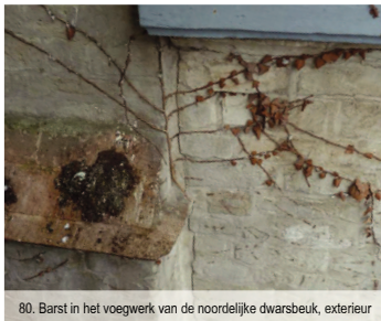
80. Barst in het voegwerk van de noordelijke dwarsbeuk, exterieur
