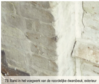
79. Barst in het voegwerk van de noordelijke dwarsbeuk, exterieur
