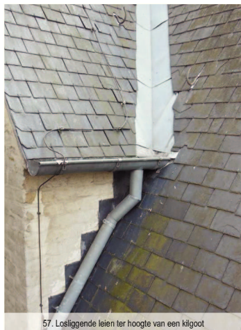
57. Losliggende leien ter hoogte van een kilgoot
