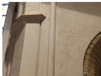
109. Zoutafzetting op de wanden en pleisterwerk ten gevolge van vocht
