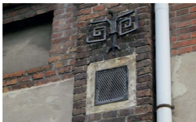
ROESTIG GEVELANKER EN -ROOSTER
