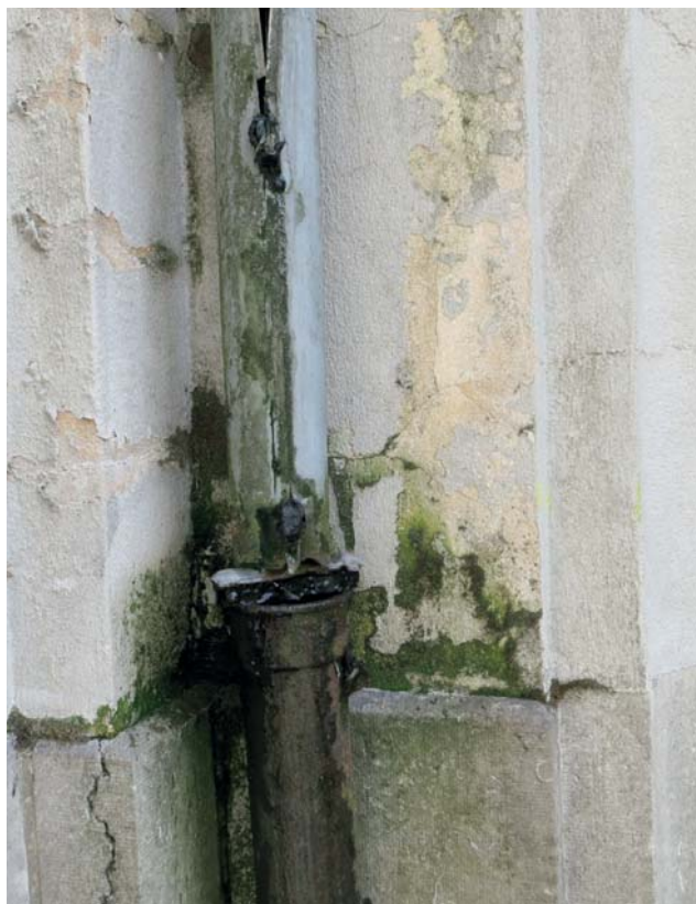
OPENGESCHEURDE ZINKEN REGENWATERAFVOER
