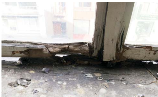
HOUTROT VAN HET HOUTEN BUITENSCHRIJNWERK
