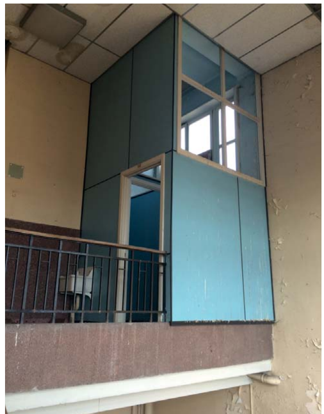
LATER TOEGEVOEGD EN ASBESTHOUDEND SANITAIR VOLUME
