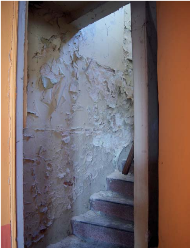
STERK GEDEGRADEERD MUURVLAK AAN TRAP TURNZAAL
