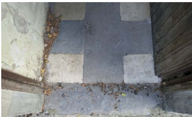
TEGELVLOER ONDERBROKEN DOOR BETONNEN STROOK
