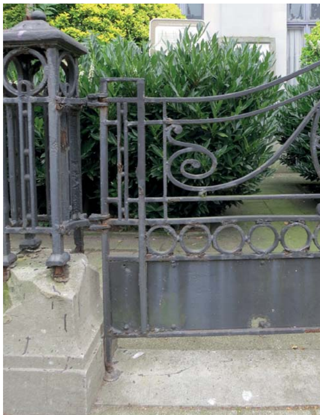
AFGESTOTEN BLAUWE HARDSTENEN DELEN AAN ROESTIGE VERANKERINGEN
