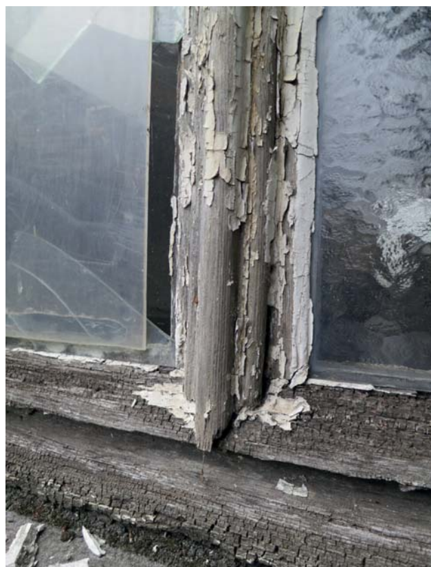
STERK VERWEERDE ONDERREGEL VAN HET HOUTEN BUITENSCHRIJNWERK
