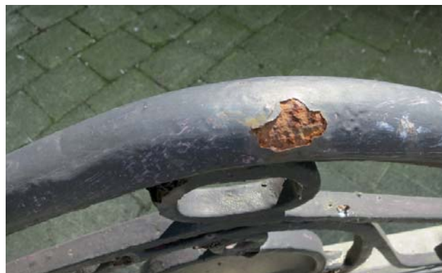
AFSCHILFEREND LAKWERK DOOR ROEST
