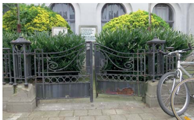
BEPALDE DELEN VAN HET HEKWERK ZIJN STERK VERROEST
