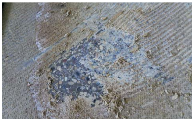
DETAIL TERRAZZO BEDEKT MET LIJMRESTEN VAN TAPIJTTEGELS
