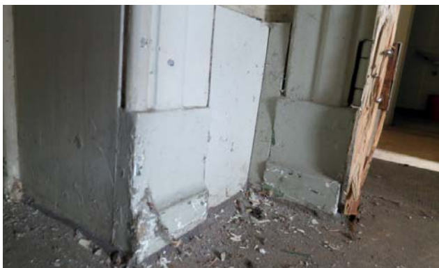
LICHT BESCHADIGDE ONDERKANT VAN HOUTEN OMLIJSTING
