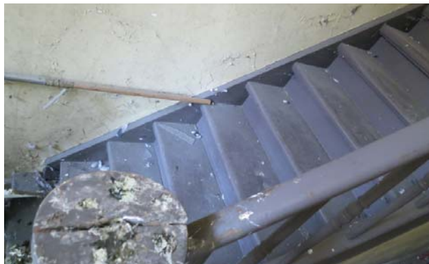
GEBARSTEN KAPITEEL VAN TRAPPAAL
