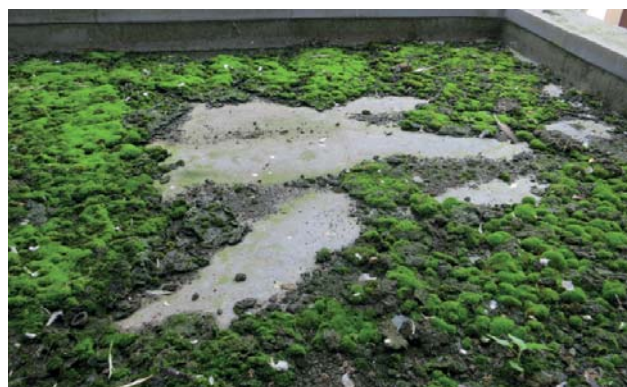
MOSBEGROEIING EN OPBOLLEN VAN ZINKEN DAKBEDEKKING OKSELPORTAAL
