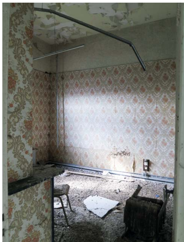
STERK VERVUILD INTERIEUR MONUMENT
