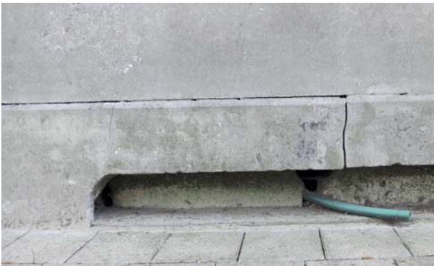
DWARSE BARST IN BLAUWE HARDSTENEN PLINT AAN KELDEROPENING
