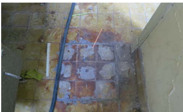
AANGETAST TEGELVLOER DOOR VERROEST TEGELDEKSEL
