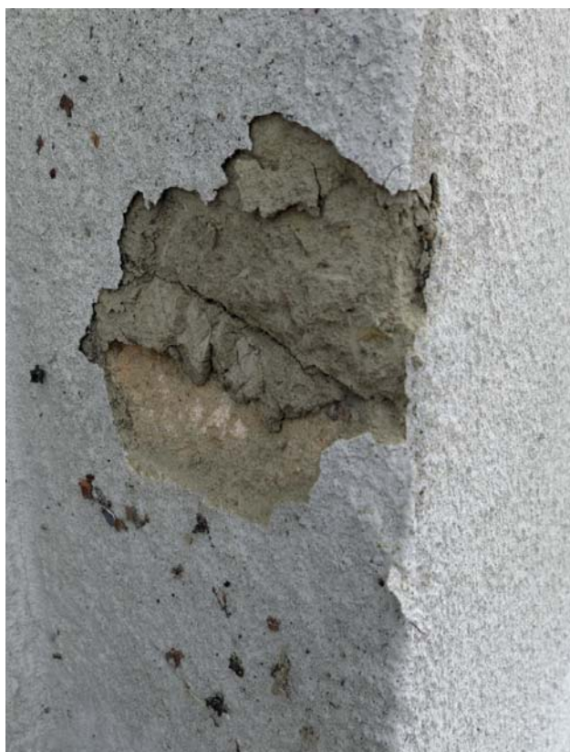
BESCHADIGDE CEMENTPLEISTER TER HOOGTE VAN DE ZIJGEVEL
