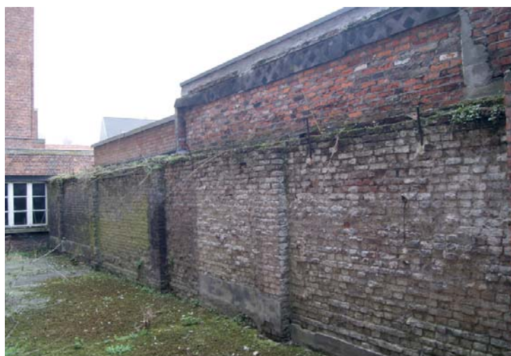
OUDE TUINMUUR MET NOG OUD BAKSTEENPARAMENT AAN ACHTERKANT KLASSENBAK
