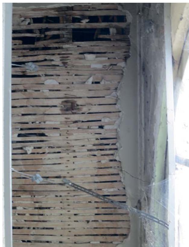
LOSGEKOMEN PLEISTERWERK TEN GEVOLGE VAN VOCHTINFILTRATIE
