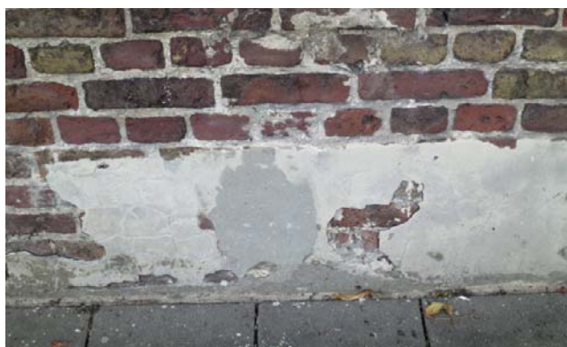
GEDEGRADEERDE GECEMENTEERDE PLINT
