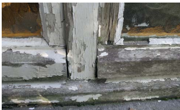
VERWEERDE ONDERREGEL BUITENSCHRIJNWERK
