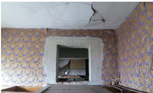
ENORME BARSTEN IN PLEISTERWERKPLAFONDS
