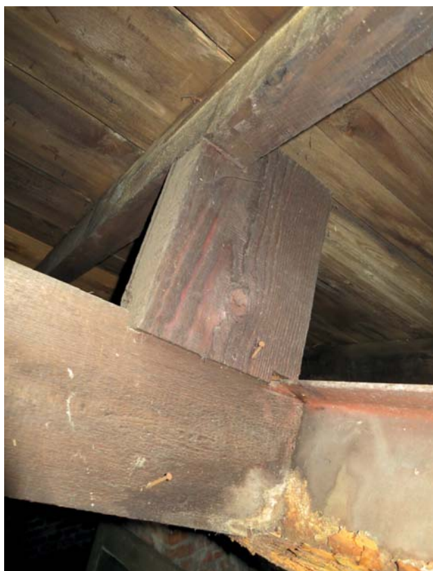
ROESTIGE METALEN LIGGER SPANTSTRUCTUUR ZOLDER
