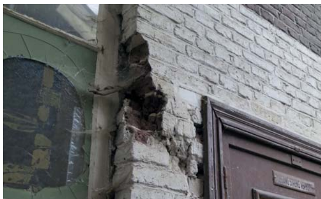
BESCHADIGD METSELWERK AAN DE ACHTERGEVEL
