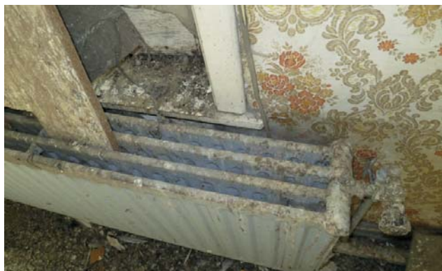
STERK VERVUILD INTERIEUR VAN HET MONUMENT
