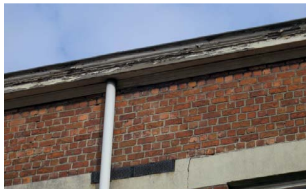
AFBLADDEN VAN DE VERF AAN HET HOUTWERK VAN DE BAKGOOT
