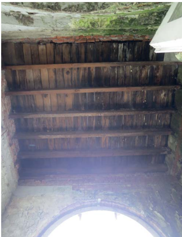
SLECHTE TOESTAND HOUTEN DAKSTRUCTUUR OKSELPORTAAL
