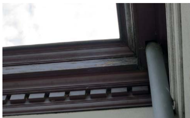
LICHT AFBLADDEN VAN DE VERFLAAG VAN DE HOUTEN BAKGOOT
