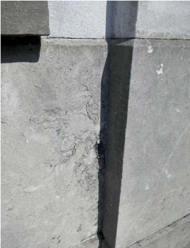
AFSCHILFEREN VAN DE BLAUWE HARDSTENEN PLINT
