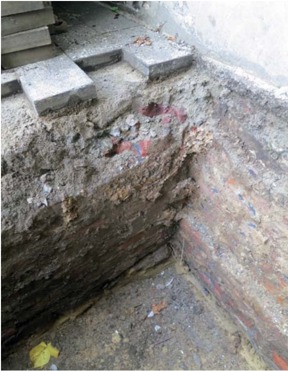
VERTANDE METSELWERK FUNDERING BESCHERMD MONUMENT
