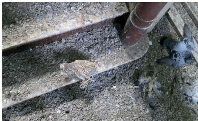
STERK VERVUILD INTERIEUR VAN HET MONUMENT
