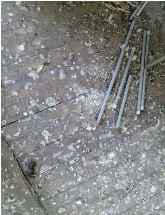
VERVUILDE HOUTEN PLANKENVLOER
